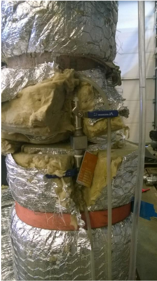
Kuvio 6 Annubar-putki savukanavaan asennettuna
