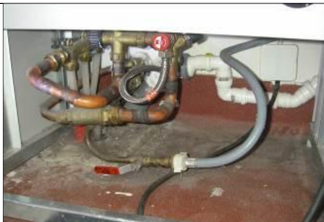
56. Näkymä lämminvesivaraajan alle kodinhoituhuoneessa
