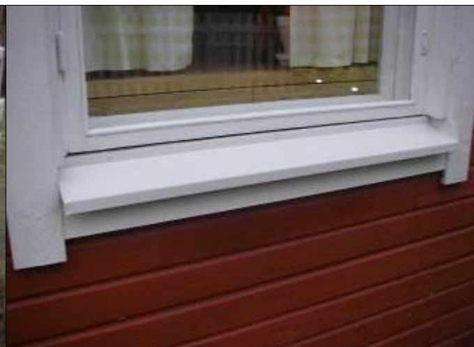
32. Rakoa ikkunapellin ja ikkunan liittymäkohdassa
