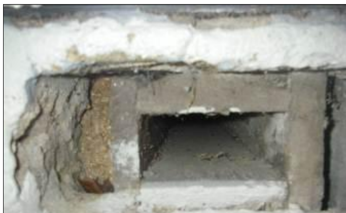
1. Näkymä keittiön kohdalla olevasta tuuletuskanavasta. Purua näkyvillä.
