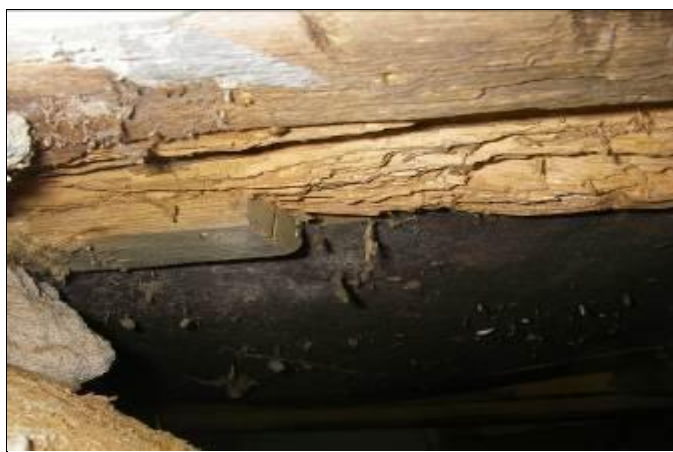
3. Näkymä alapohjatilaa olohuoneen kohdalla rakennuksen päädystä. Vaurioitunutta puuta- varaa tuuletusaukon läheisyydessä.
