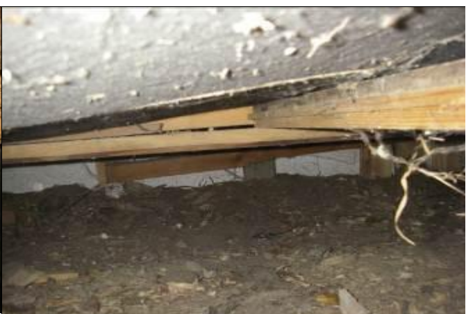
4. Näkymä alapohjatilaa takapihan puolelta suu-remmasta tuuletusaukosta. Tuulensuojalevy on osittain irti.
