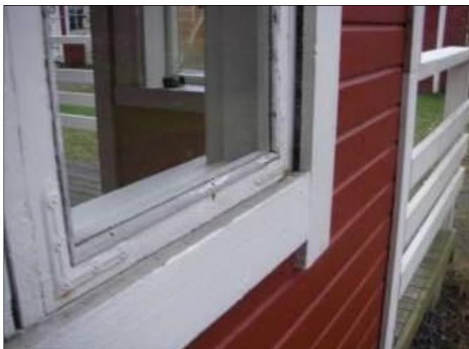
31. Rakoa verannan ikkunan ja ikkunan pielilaudan liittymäkohdassa
