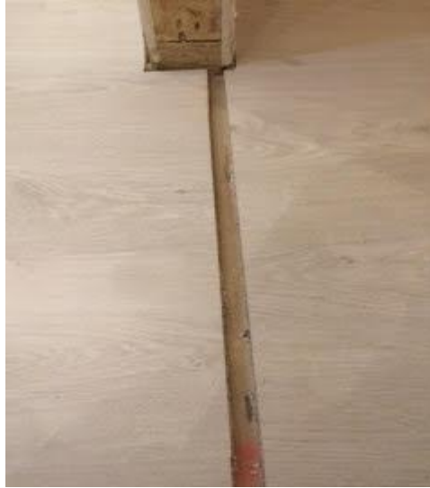
Kuva 32. Liikuntasauva lattiassa oven kohdalla.
