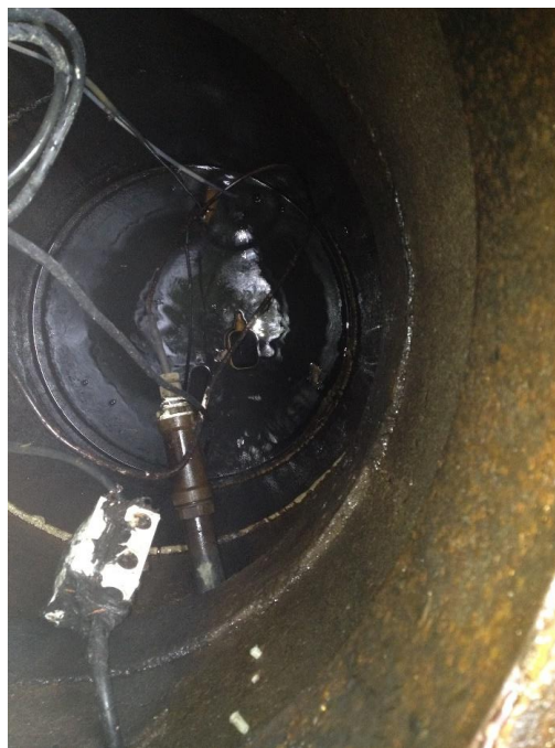
Kuvat 3 ja 4. Perinteisellä uppopumpulla varustettu esimerkkikaivo (hulevesille) asfalttipihalta [2].
