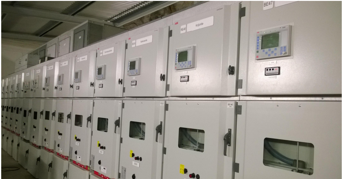
Kuva 12. UniGear kojeisto käyttöönottokunnossa
