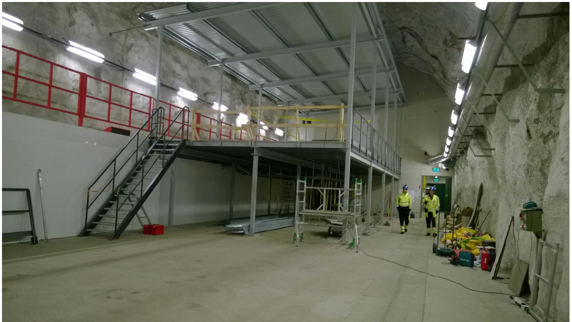
Kuva 4. Uuden 20 kV kojeiston taso
