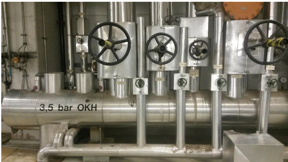
KUVA 4 Seinäjoen voimalaitoksen omakäyttöhöyrytutki
