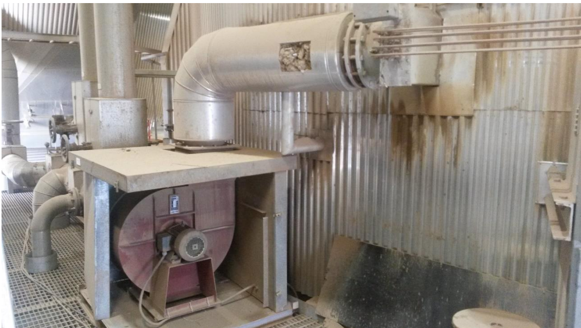
KUVA 16 Seinäjoen voimalaitoksen luvon laakerin hätäjähdytyspuhallin
