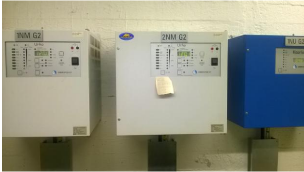
Kuva 7. Tasasuuntaajat akustojen lataukseen.
