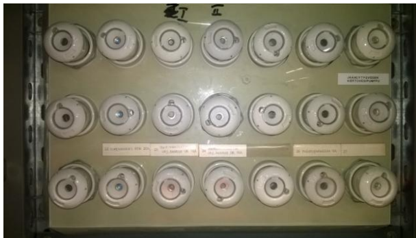
Kuva 6. Vuotovesikaivon pumppujen sulakkeet ovat alarivin oikealta kolmas ja neljäs tulpasulake.
