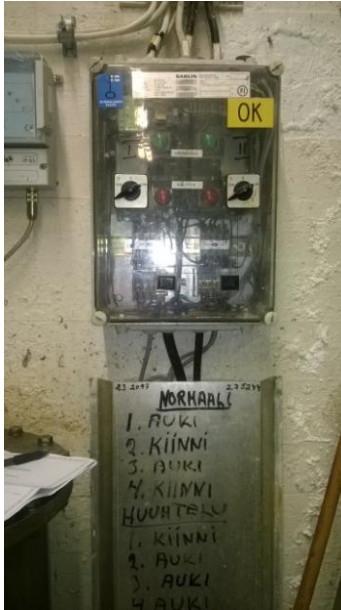
Kuva 5. Vuotovesikaivon pumppujen ohjauskeskus.
