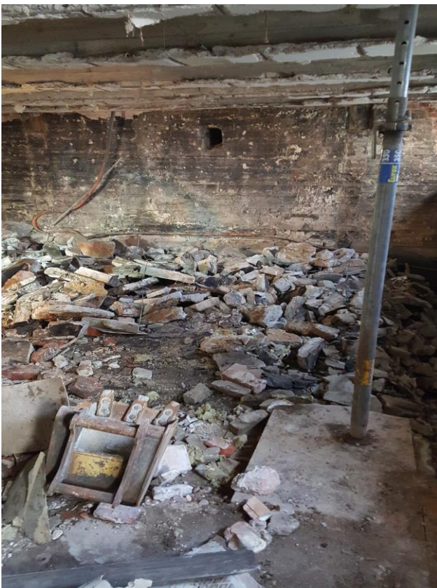
KUVA 8. Purkutyön jäljiltä betonilaattaa
