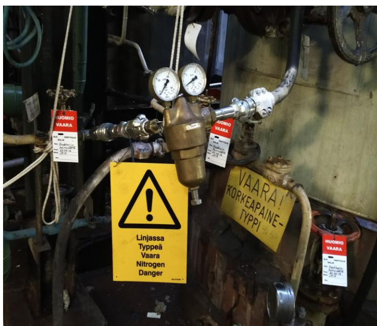
KUVA 14. Paineenalennusventtiili (Kuva: Arttu Tuominen 2016)
