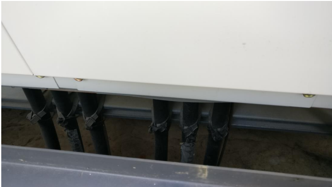
Kuva 29. Muuntamon 4040 kojeistoon menevät kj-kaapelit ja keskusköydet.
