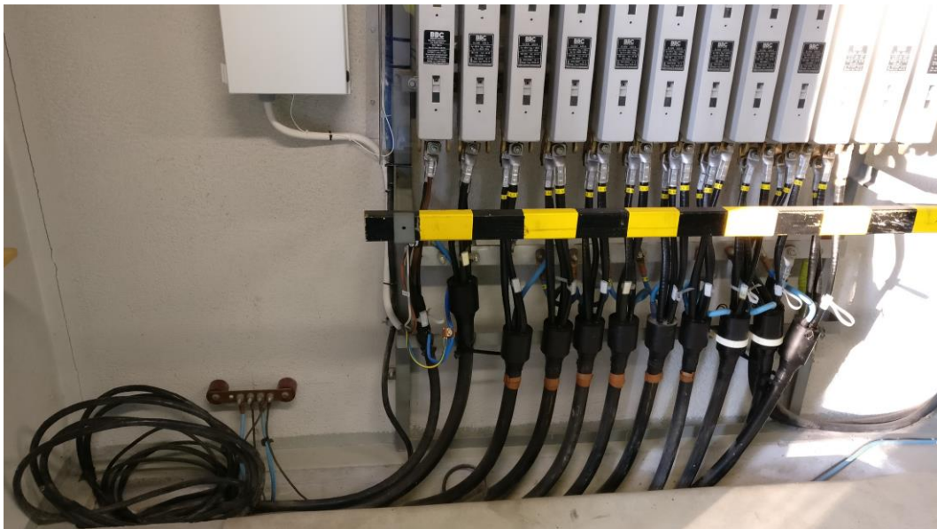
Kuva 25. Muuntamon 641 pj-keskus ja potentiaalintasauskisko.
