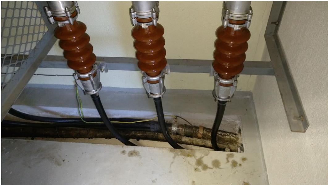
Kuva 26. Muuntamon 641 keskijännitekaapelien vaippojen maadoitukset.
