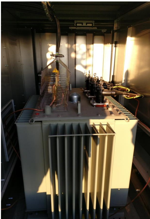
Kuva 33. Muuntamon 4229 jakelumuuntajan maadoitukset.
