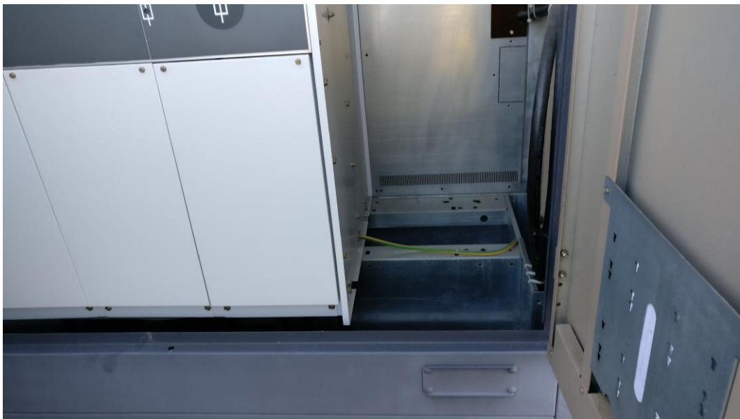
Kuva 30. Muuntamon 4040 kojeistosta lähtevä maadoitusyhteys potentiaalintasauskiskoon.
