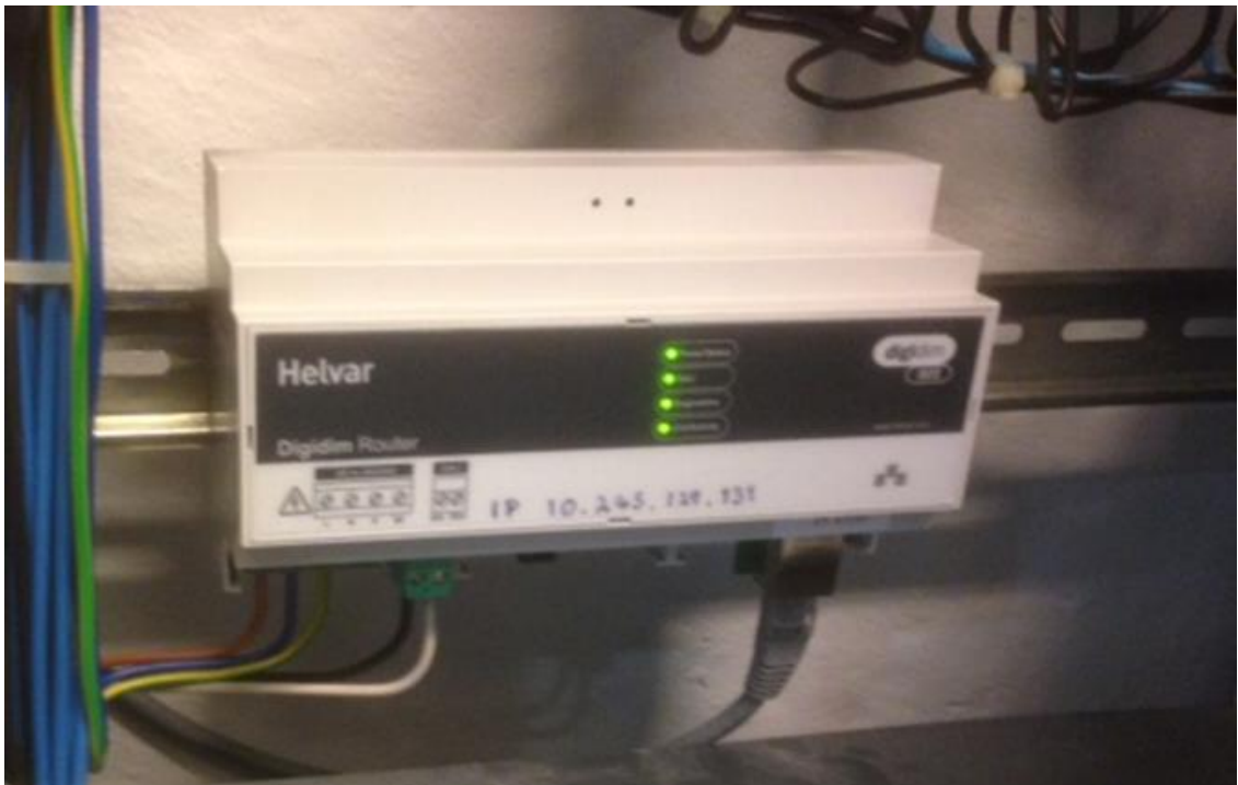
Kuva 17. Helvar digidim 905 -reititin asennettuna ryhmäkeskukseen
