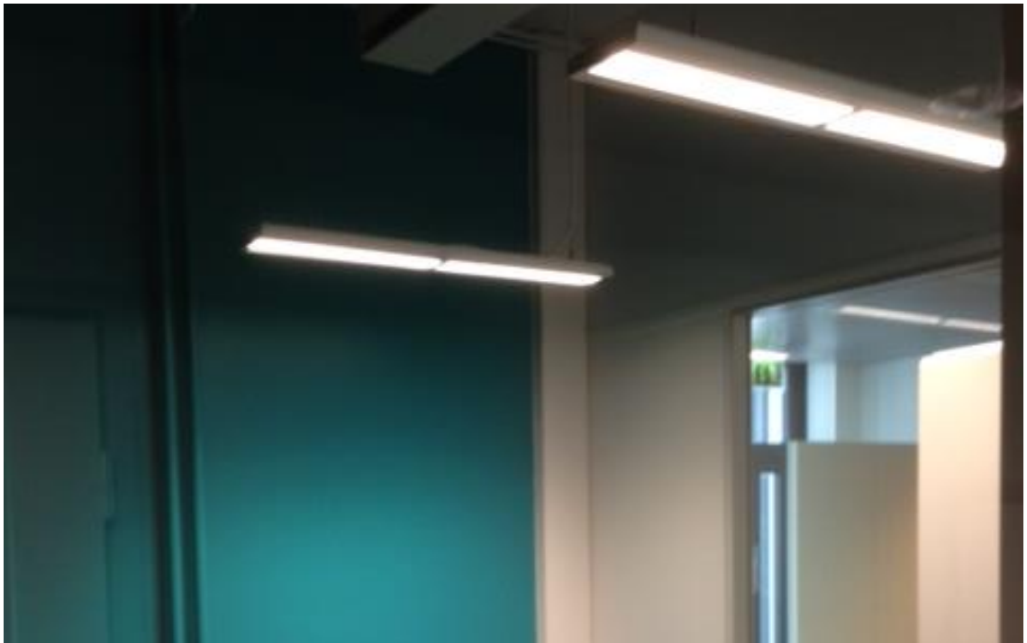
Kuva 13. Philips CoreLine LED34S/840 -valaisimet asennettuina neuvottelutilaan
