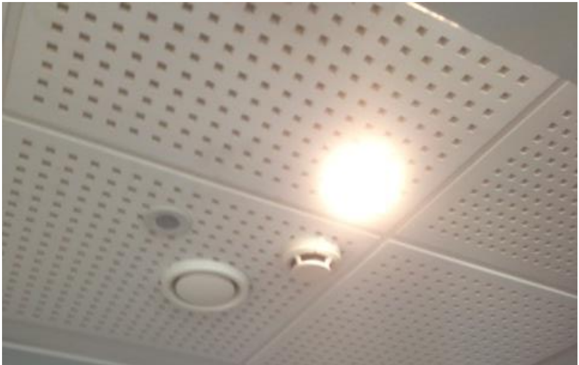
Kuva 12. Winled liris 10 W / 4000 k -valaisin asennettuna puhelujen vastaanottoon tarkoitettuun tilaan
