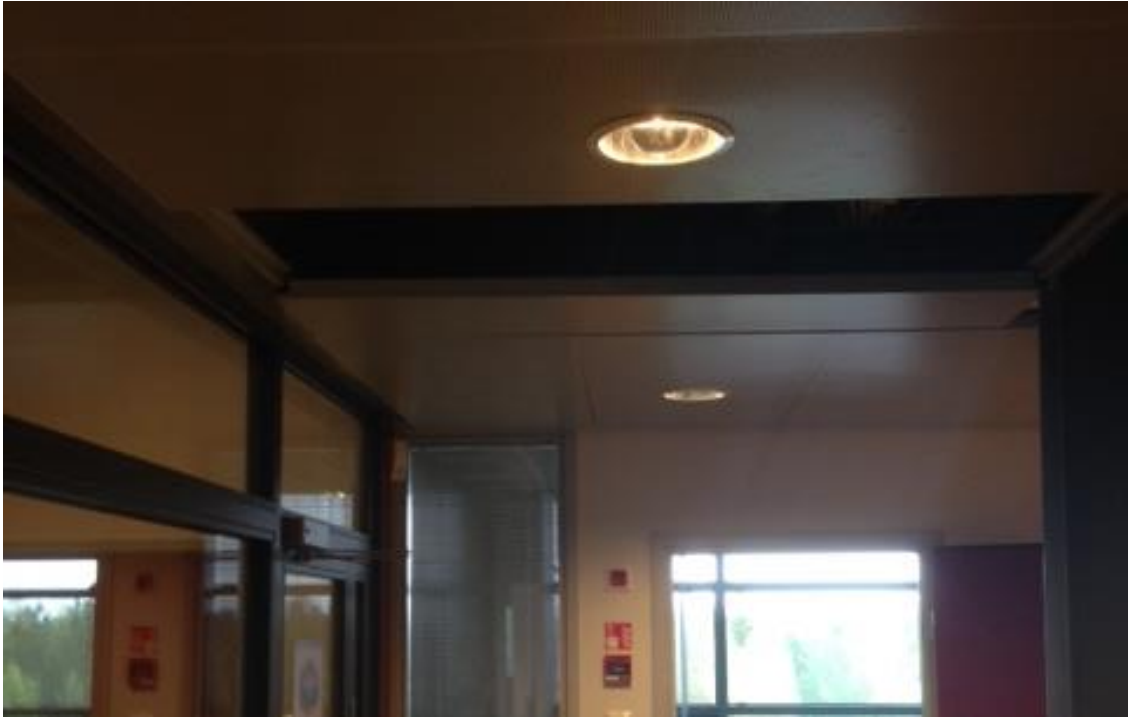
Kuva 10. Käytävötilöjen vanhat pienloistepötkivalaisimet
