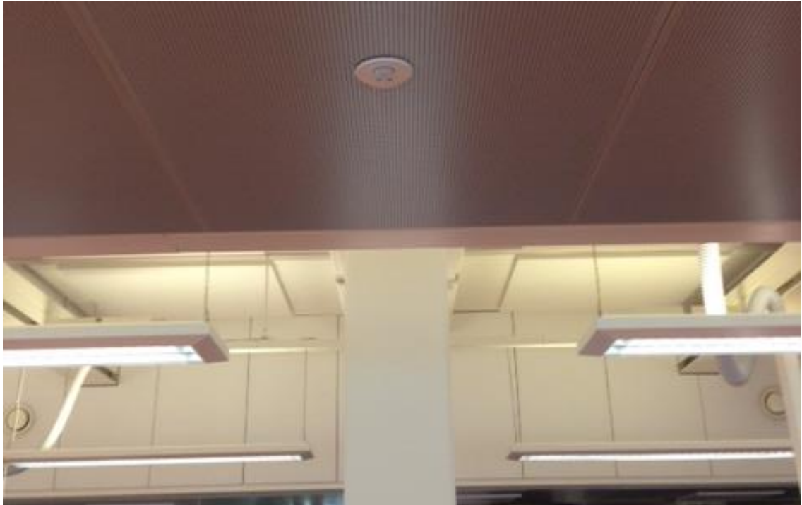
Kuva 15. Helvar digidim 312 -multisensori asennettuna alaslaskukattoon
