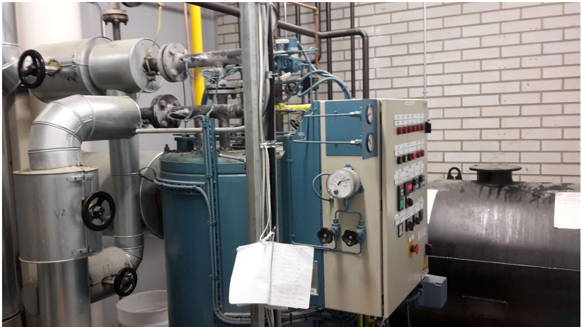
KUVA 8. Linjastoa lämmittävä öljykattila
