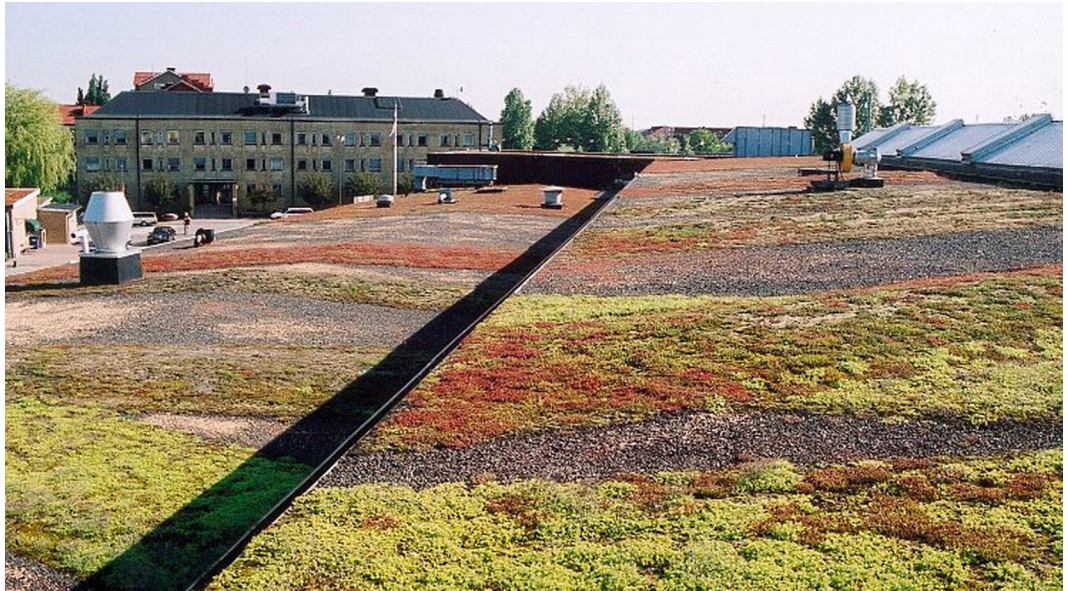
Kuva 2. Ruotsin Augustenborgin 95 aarin laajuinen ekstensiivinen kattopuutarha. (Green Roof Center.)
