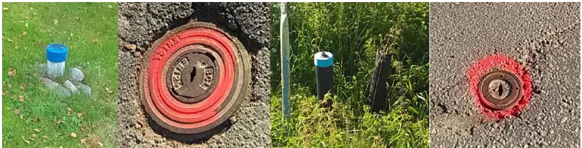
Kuvio 10. Erilaisia vesijohtoventtiilien kansia ja suojaputkia
