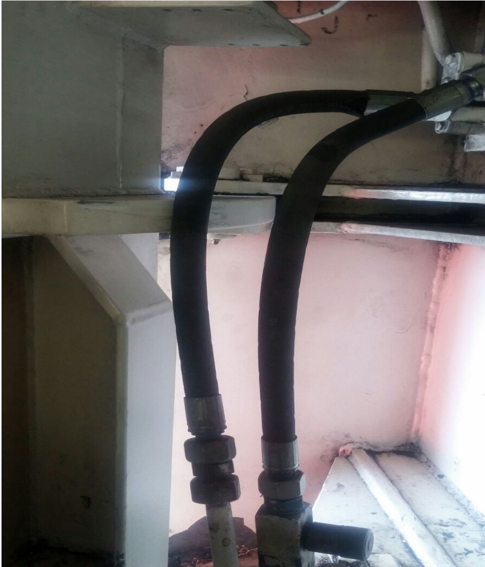
Kuva 8. Taaempi letku on vaurioitunut yläpäästä ja letkut jäävät oven väliin puristukseen.
