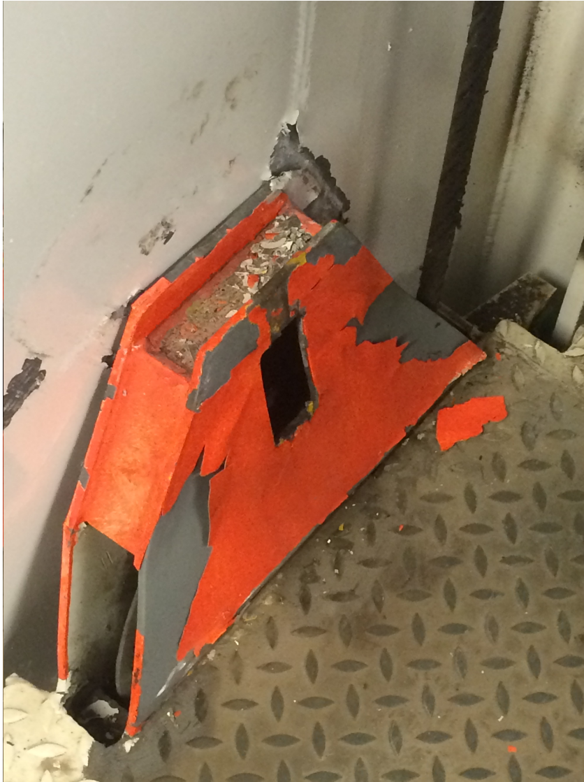
Kuva 14. Lukitus jäänyt kiinni ja vääntänyt vaijeripyöränsuojan käyttökelttomaksi.
