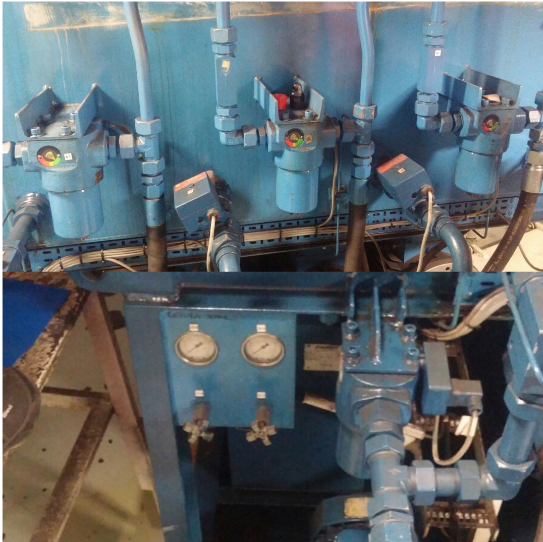
Kuva 9. Hydraulikoneikossa vuotoja filttareissä ja liittimissä.
