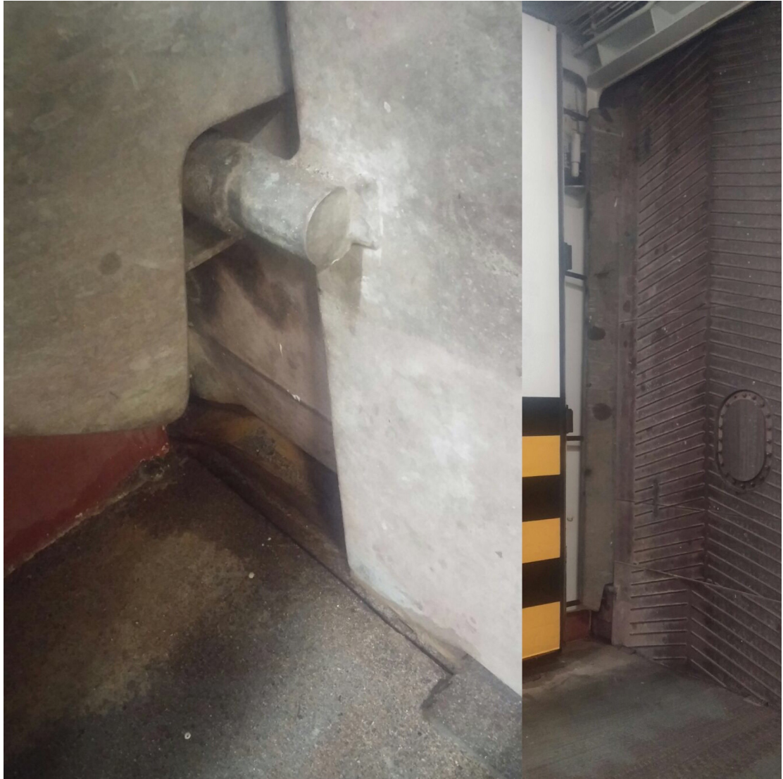
Kuva 3. Kuvan 2 vuodon kohta perärampissa.
