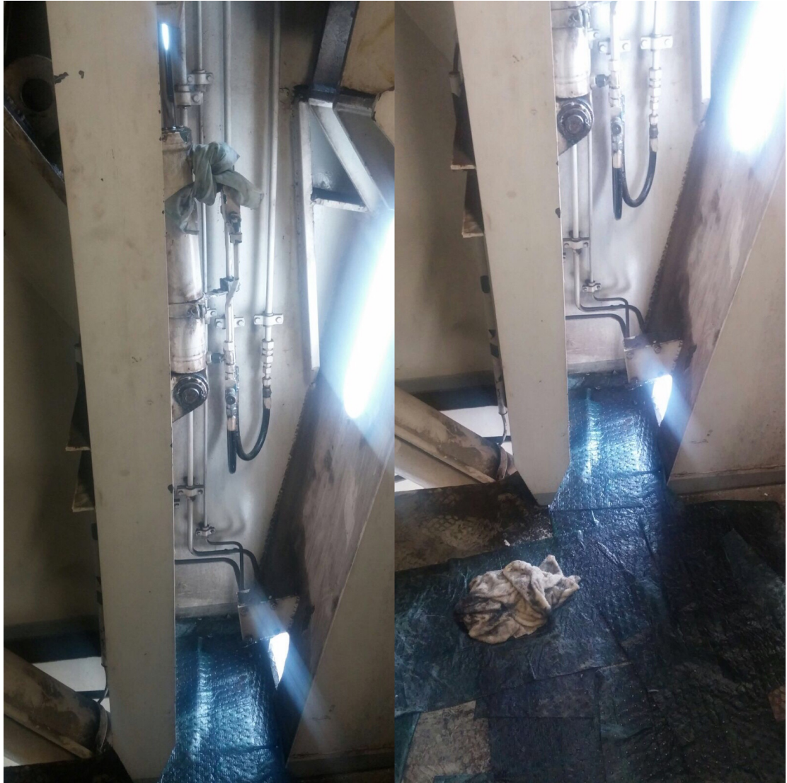
Kuva 20. Esimerkki välinpitämättömydestä sylinterin vuotoa kohtaan. Ei näin!
