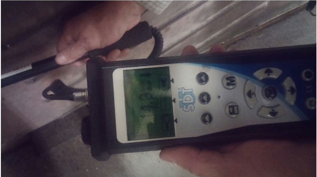
Kuva 2. Ultraääni -tiivetyksmittarin vastaanotin ja 14,8%:n vuoto löytynyt.
