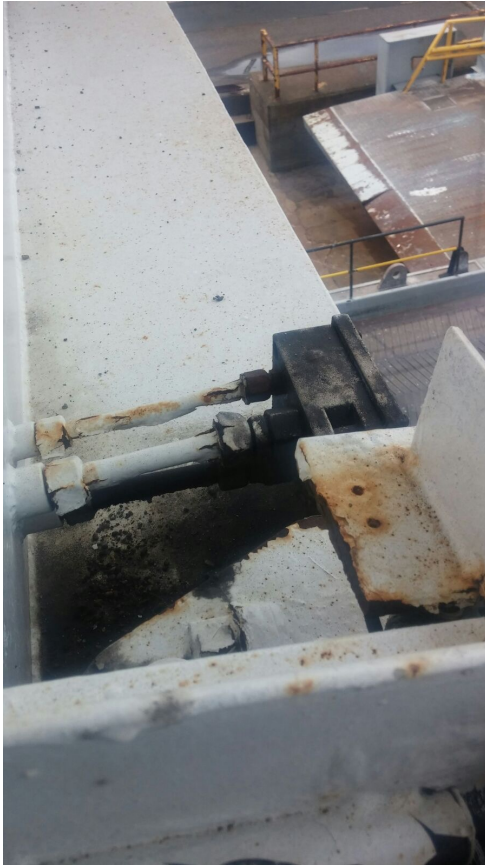
Kuva 10. Pahasti ruostuneet putken pätkät, jotka ovat sääolosuhteiden armoilla.
