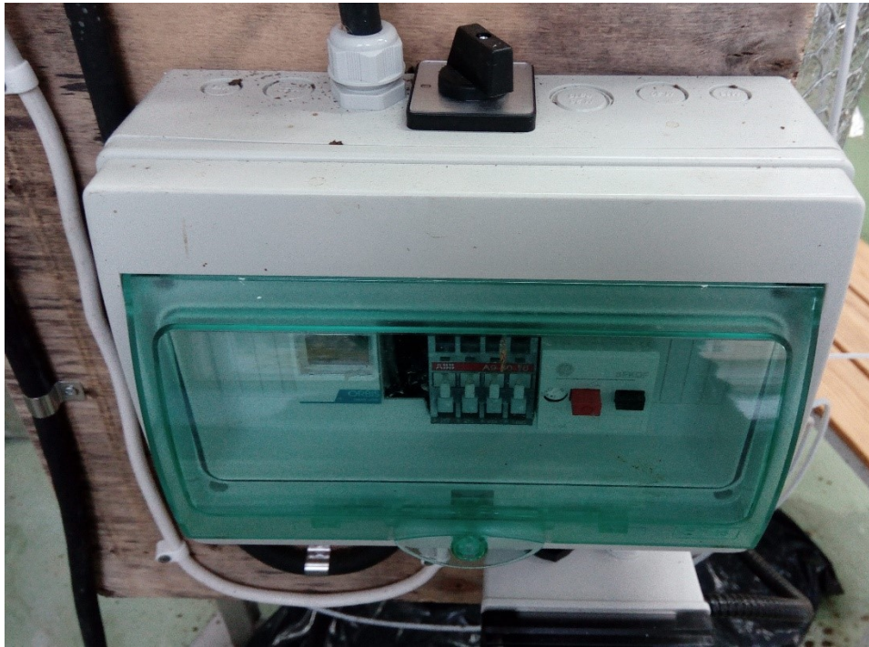
Kuva 9. Sekoitinmoottorin ohjauskotelo. Kotelon päällä on manuaalinen pois-kytkentä, sisällä kotelossa aikakytin, ohjausrele ja moottorinsuojakytin.
