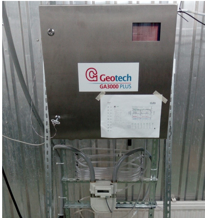
Kuva 10. Biokaasun analysointilaitteisto. Harmaata kaasujohtoa (vasemmalla) pitkin tuleva biokaasu johdetaan kaasumäärämittarille, josta kaasu kulkee ”letkukiepin” kautta analysaattorille.
