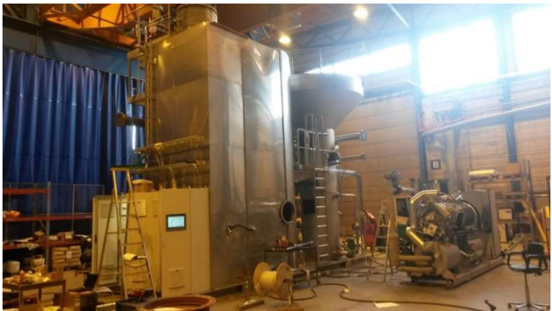
KUVIO 29 Laitteisto sähköasennukset rakennusvaiheessa, sekä FAT –testaus
