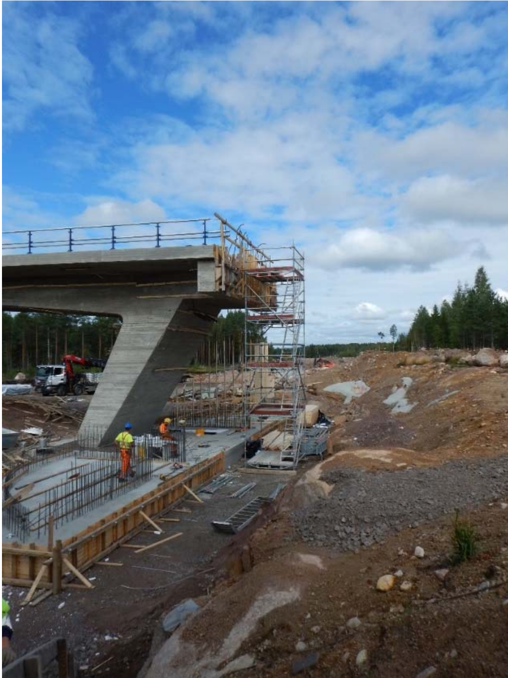
KUVA 4. Siirrettävä teline eli porrastorni
