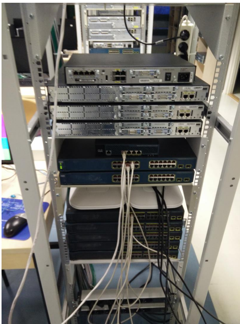
KUVA 11 Tietoverkko testauksia varten.
