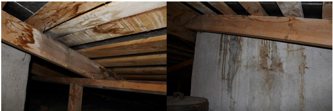
Kuva 18. Vanhan vesivuodon jälkiä
