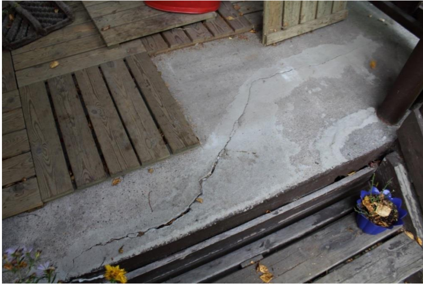
Kuva 23. Verannan betonilattian halkeama
