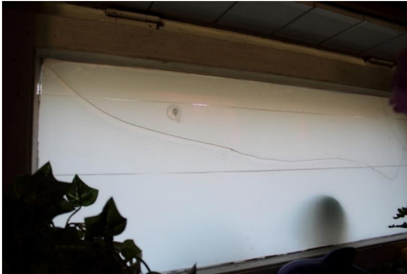
Kuva 15. Pesuhuoneen haljennut ikkuna
