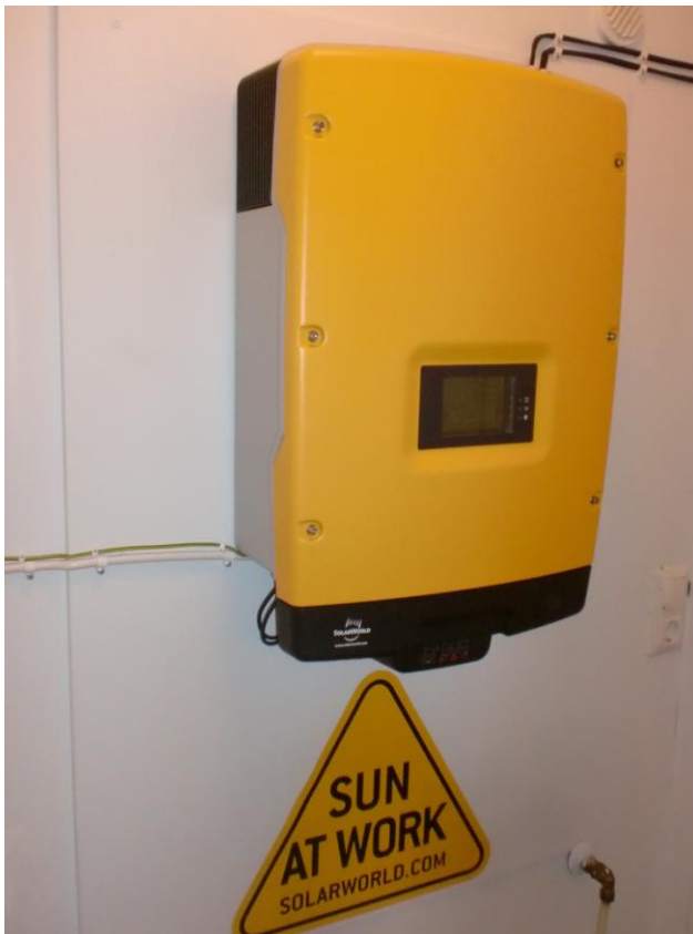
Kuva 6. Invertteri asennettuna palamattomaan seinälevyyn tekniseen tilaan (Kuva: Timo Nykänen).
