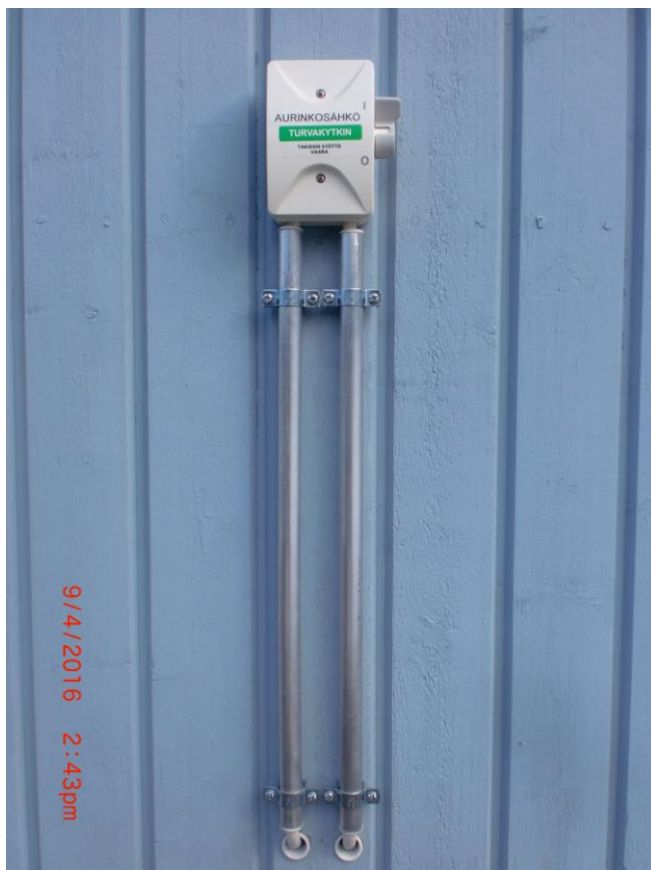
Kuva 7. AC-turvakytkin ja läpiviennit MMJ-kaapeleille tekniseen tilaan ja UV-suojaus alumiiniputkella (Kuva: Timo Nykänen).
