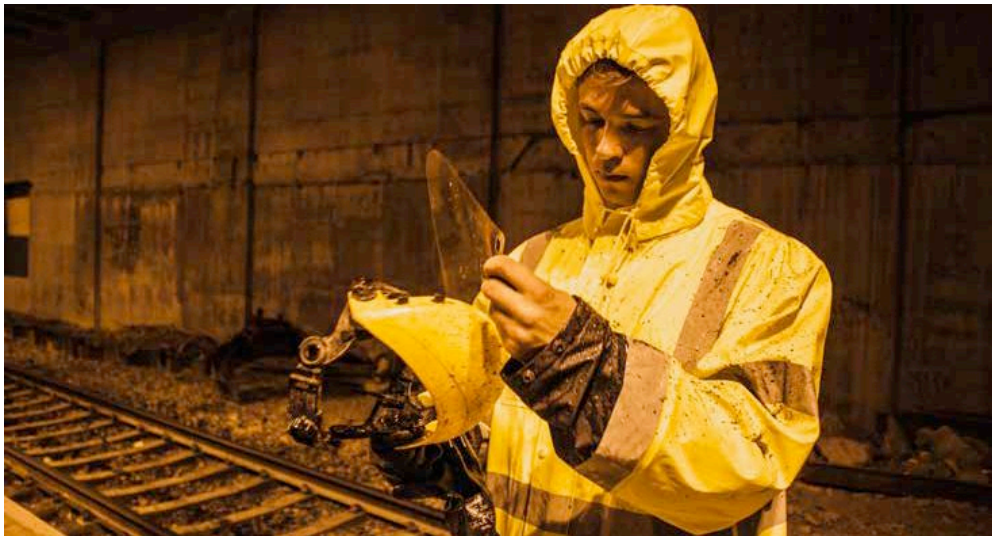
Pesupalvelu Hans Langhin työntekijä puhdistaa suojavälineitään työmaalla. Vesipiikkauksessa betoni- ja kivimurskaa lentää jatkuvasti työntekijän päälle ja ympäristöön, mikä on otettava huomioon työn turvallisuutta suunniteltaessa.
