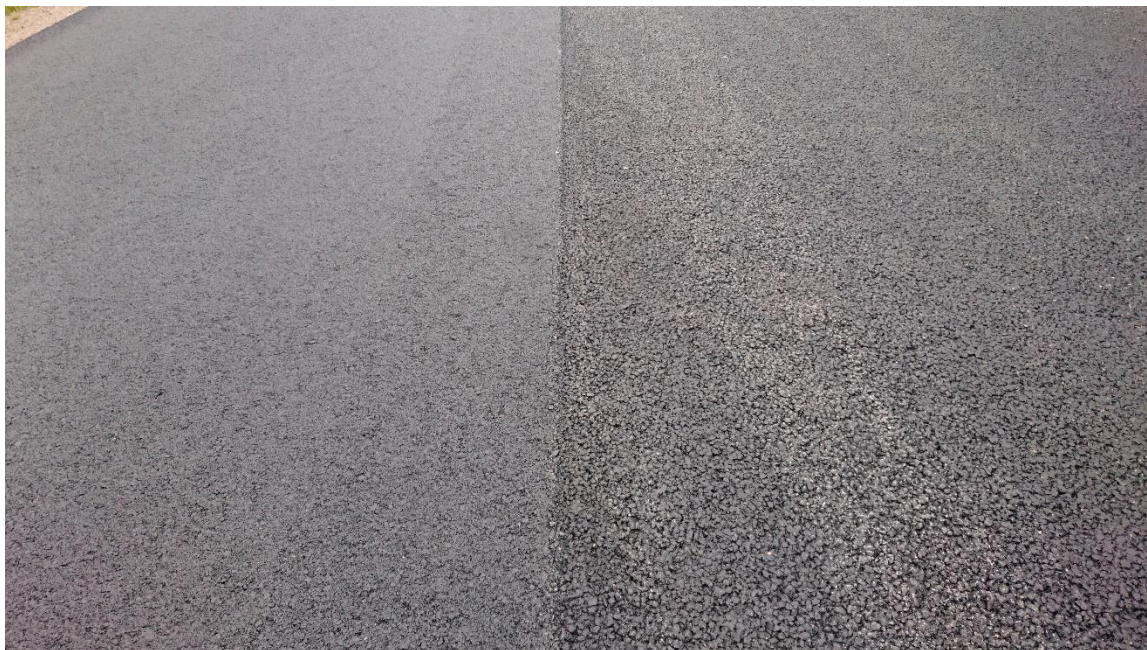
Kuva2. AB16-asfaltti (vasemmalla) ja SMA16-asfaltti (oikealla) ero (Ukkola 15-6-2016)
