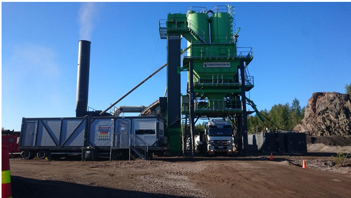
Kuva 20. Siirrettävä asfalttiasema Amomatic. (Ukkola 2016-8-29)
