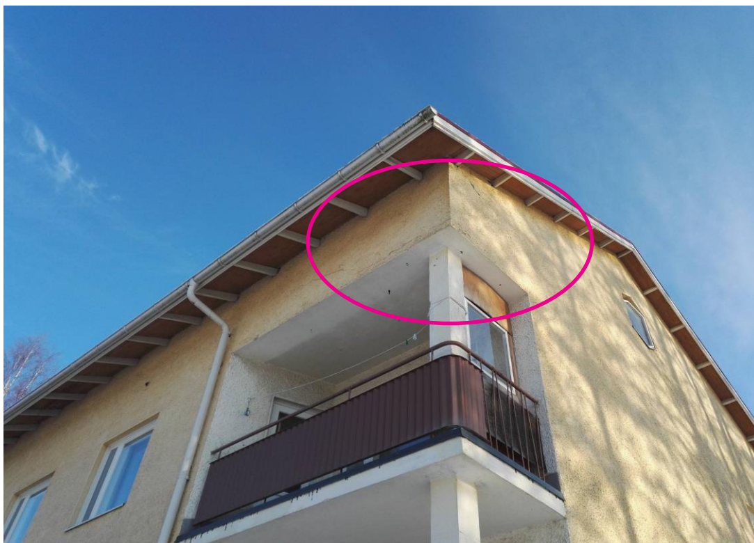
Kuva 5. Rappauksessa halkeamia (Partanen 2016-11-02)
