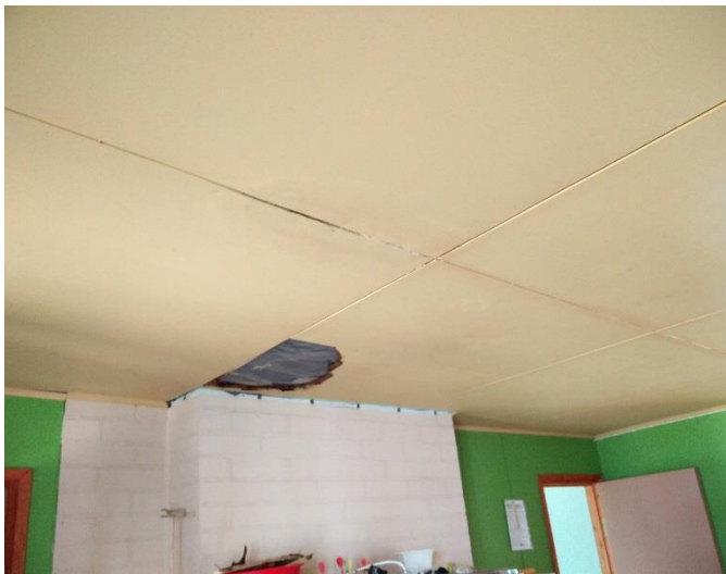
Kosteusjälkiä savupiipun luona sisäpuolella
