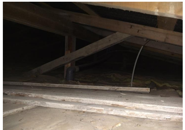
Viemärin tuuletusputki eristämättä
