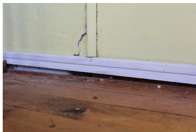
KUVA 24. Alapohja painunut (Antti Koponen 2016).
