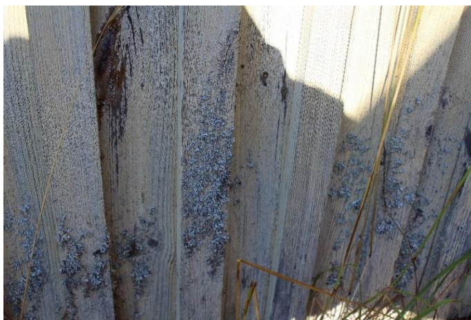
KUVA 11. Julkisivulaudoituksessa on naavaa (Antti Koponen 2016).
