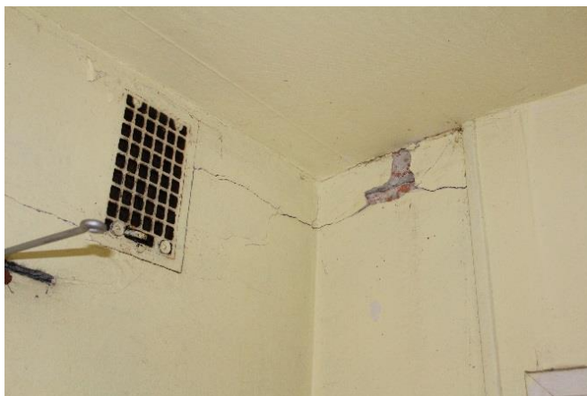
KUVA 18. Hormissa on vaurioita (Antti Koponen 2016).
