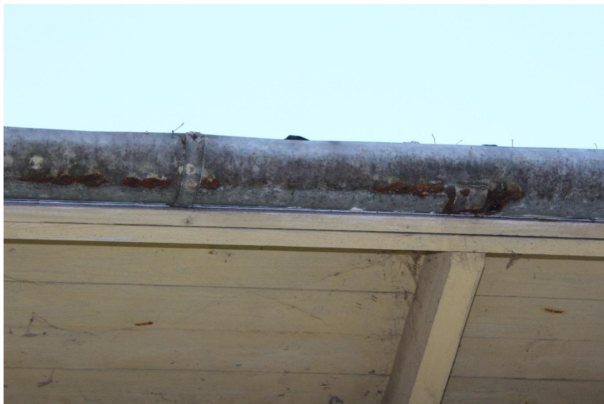
KUVA 20. Räystäskourut ovat hapettuneet (Antti Koponen 2016).
