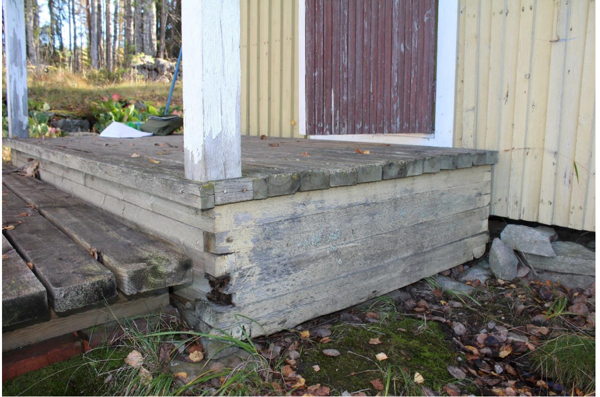
KUVA 15. Kuistin runko on vaurioitunut (Antti Koponen 2016).
