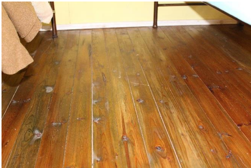
KUVA 27. Lattialaudoituksessa värimuutosta (Antti Koponen 2016).
