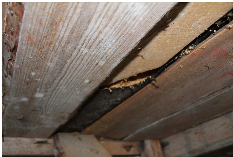
KUVA 10. Pintalauta on irronnut alapohjasta. Rakenteessa on reikä. (Antti Koponen 2016.)
