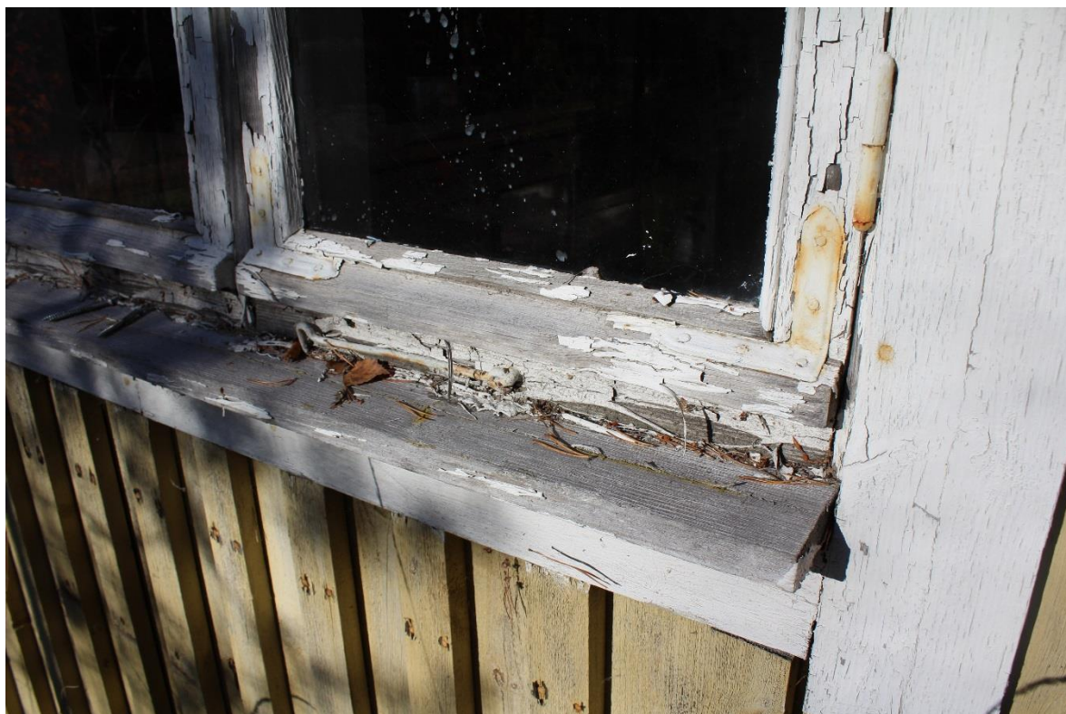
KUVA 16. Ikkunan puitteet ja tippalauta ovat korjauksen tarpeessa (Antti Koponen 2016).
