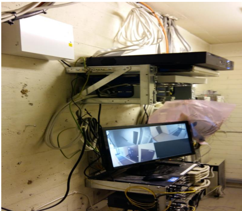
Kuva 12. Laitetilaan asennettu tallennin ja monitori.
