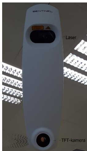
KUVA 8. Sentinelyksikkö kuvaushuoneen katossa.
