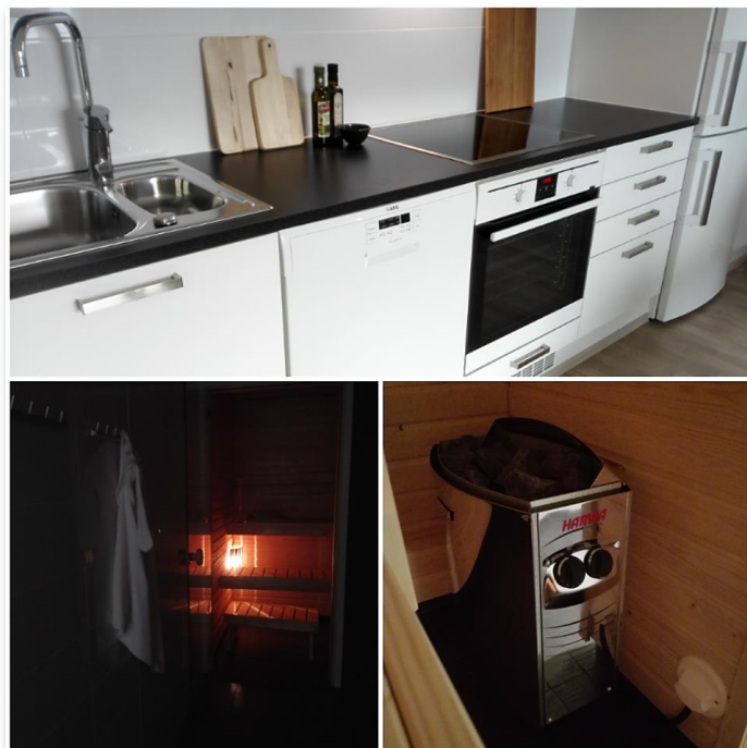
Kuva 10: Toimintakokeiden lisäksi asuntojen kodinkoneille ja laitteille, kuten kiukaalle ja astianpesukoneelle, suoritetaan käyttökokeet ennen rakennuskohteen luovutusta [41].
