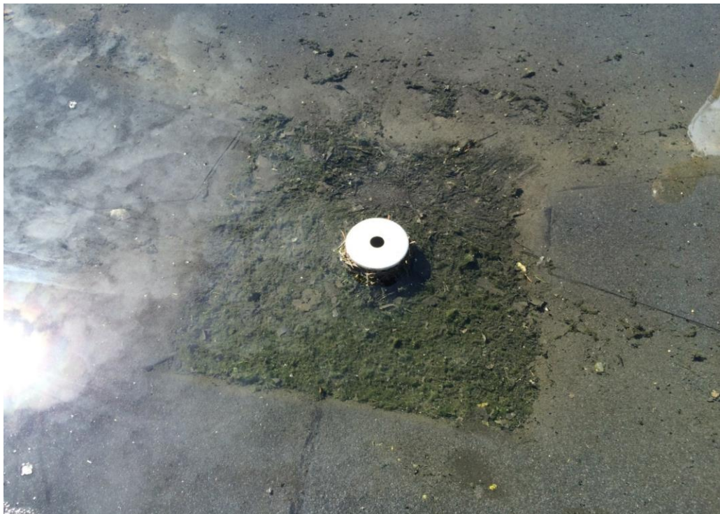
Kuva 7. Karhuvuoren urheilutalon kattokaivon tukkeutunut roskasihti. Antti Auervolle 2016.
