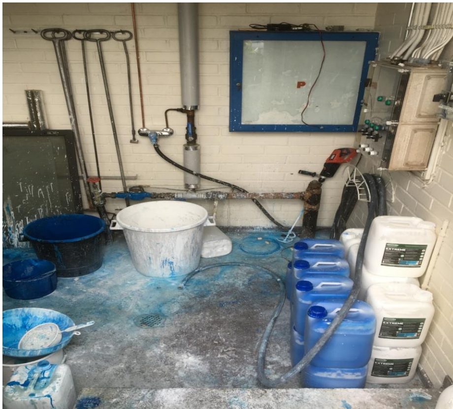
Kuva 14. Puistolan urheilukentän lämmönjakohuone. Antti Auervuolle 2016.
