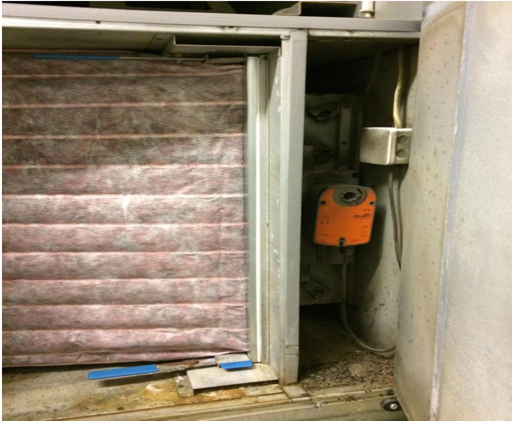
Kuva 2. Karhulan kilpajäähallin ilmakonehuoneen ilmanvaihtokoneen suodatintila. Antti Auervuolle 2016.
