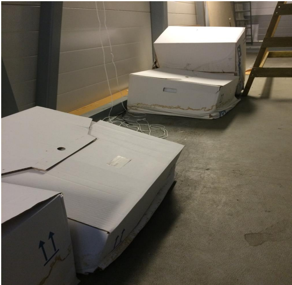
Kuva 5. Karhulan kilpajäähallin ilmakonehuoneen suodatinpaketit. Tilassa sijaitsee myös kylmätekniikkakoneita. Antti Auervuolle 2016.
