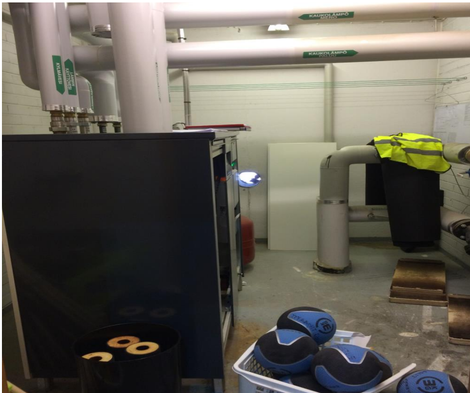
Kuva 10. Kotkan urheiluhallin lämmönjakohuone. Antti Auervolle 2016.
