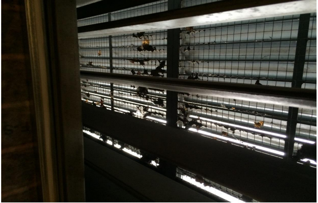
Kuva 4. Karhulan kilpajäähallin ilmakonehuoneen tuloilmasäleikkö. Antti Auervuolle 2016.
