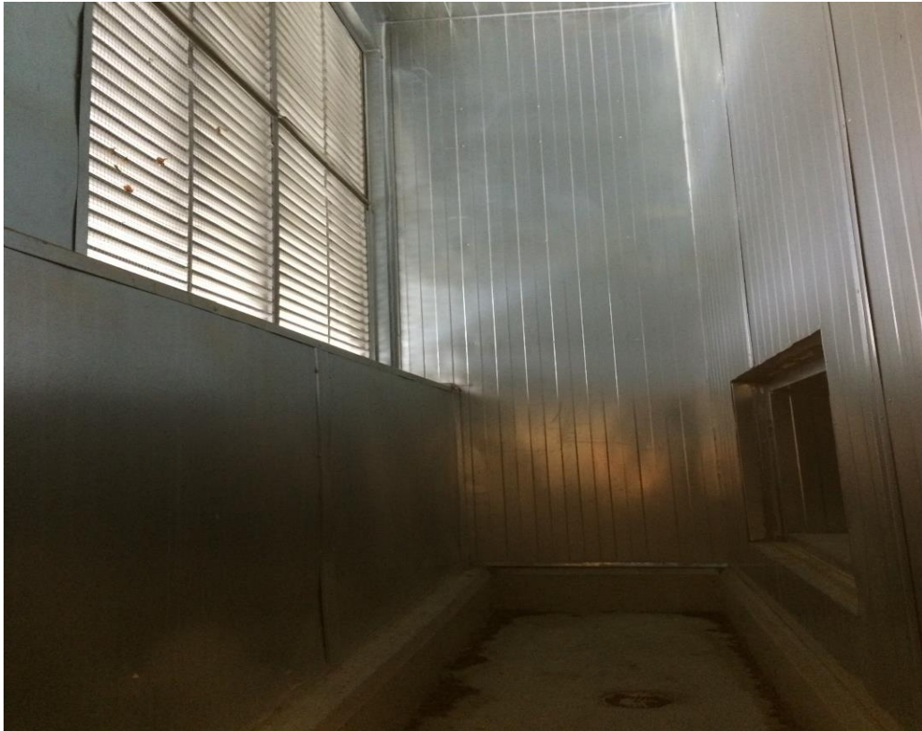
Kuva 8. Karhuvuoren urheilutalon ilmakonehuoneen tuloilmasäleikön tila. Antti Auervuolle 2016.
