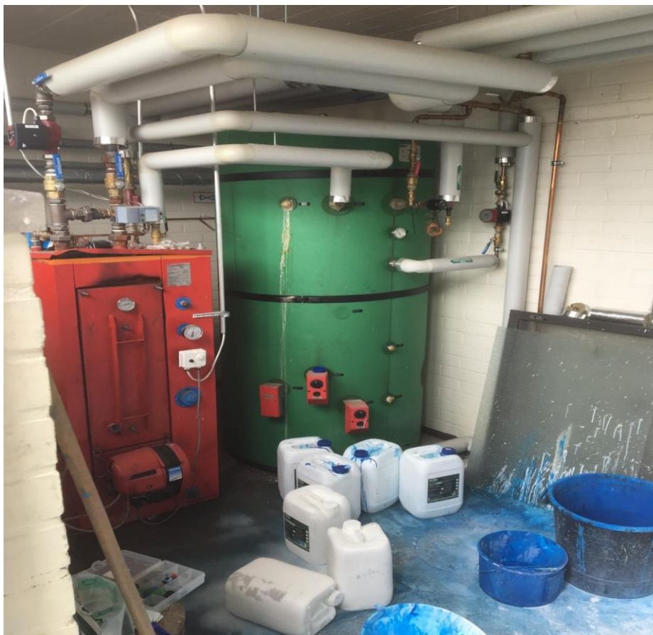
Kuva 15. Puistolän urheilukentän lämmönjakuhuone. Tila on sama kuin kuvassa 14, mutta eri kuvakulmasta. Antti Auervuolle 2016.
