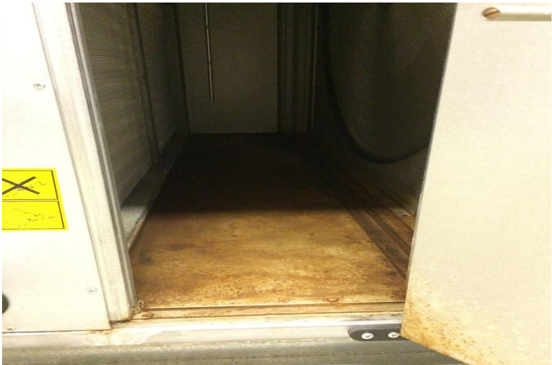
Kuva 3. Karhulan kilpajäähallin ilmakonehuoneen ilmanvaihtokoneen kondenssiveden ruostuttama pohja. Antti Auervuolle 2016.
