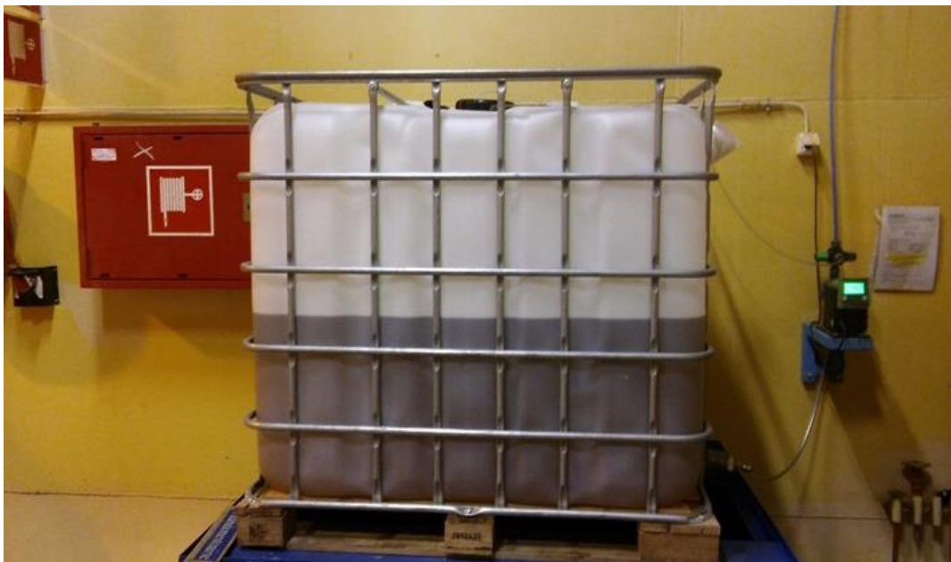
Kuva 40. Kemikaalin syöttö on automatisoitu.
