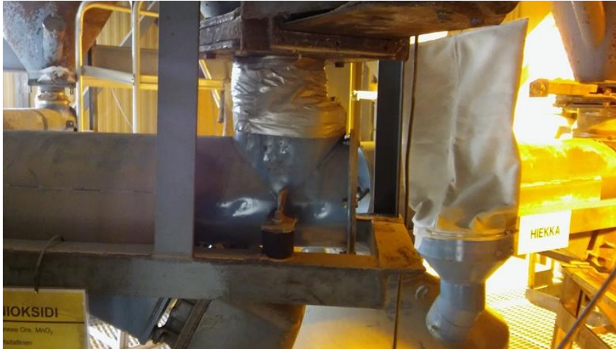
Kuva 19. Teipillä korjattua putkistoa.
