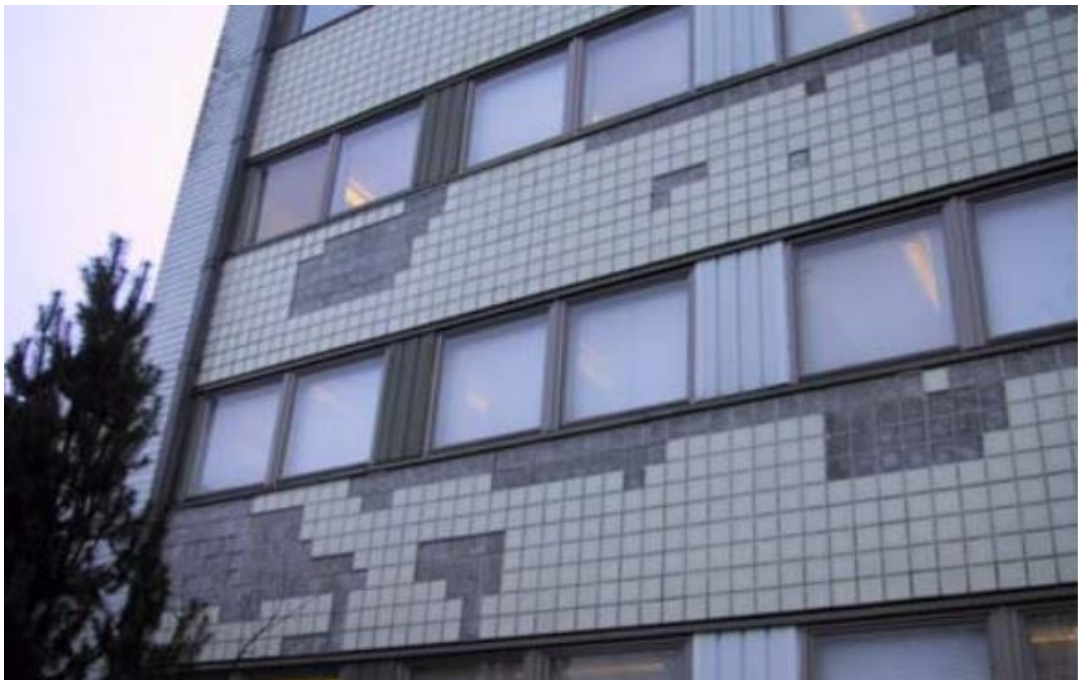
Kuva 16. Klinkkerilaatan irtoamista julkisivussa. [6 s. 12.]
