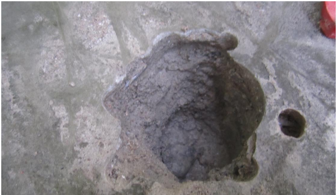
Kuva 11. Varhaispakkasrapautuman seurauksena lujuutensa täysin menettänyt betonilaatta [Kristian Koskenniemi]
