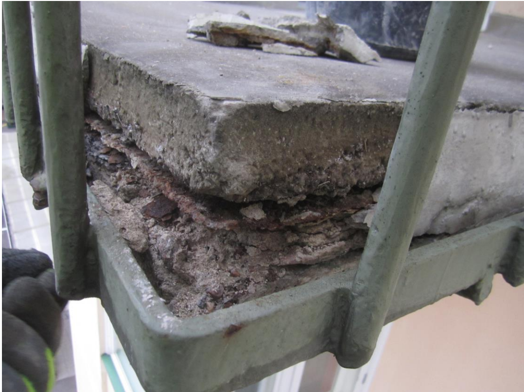
Kuva 15. Parvekelaatan etureunan yli johdetun vedenpoiston aiheuttama vaurio [Kristian Koskenniemi]
