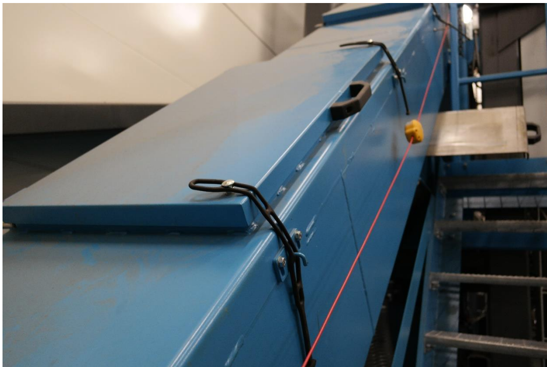
KUVA 6. Kolakuljettimen kansi sekä köysihätäpysäyttimen köysi. Kolakuljettimen oikealla puolella on ryöstöpelti ulosvedettynä.
