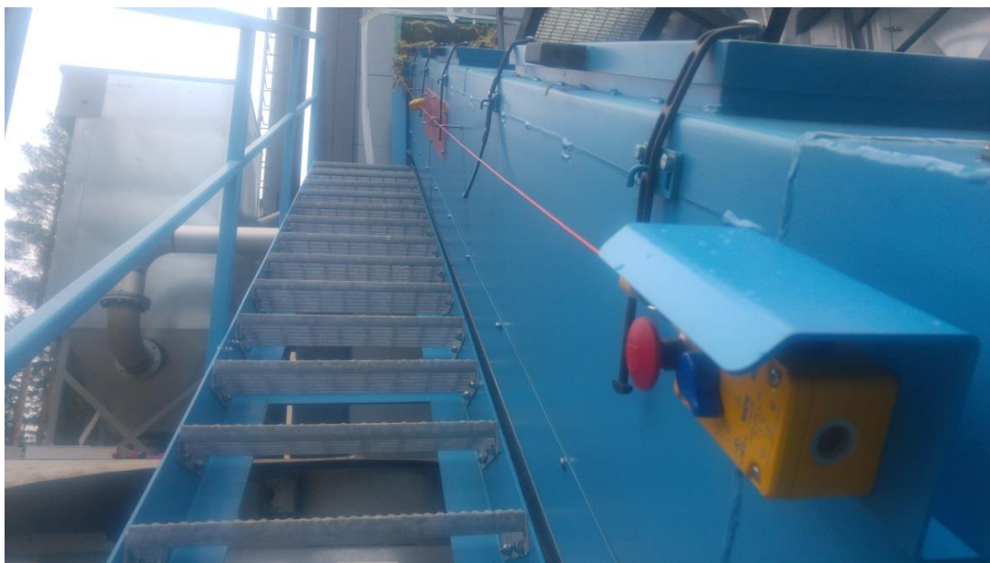
KUVA 13. Köysihätäpysäytin kolakuljettimen nousuosassa
