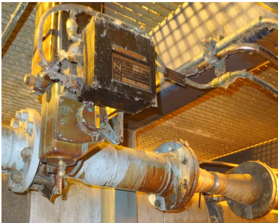
Kuva 13. Ilman säätöön liittyneet venttiili ja venturiputki.
