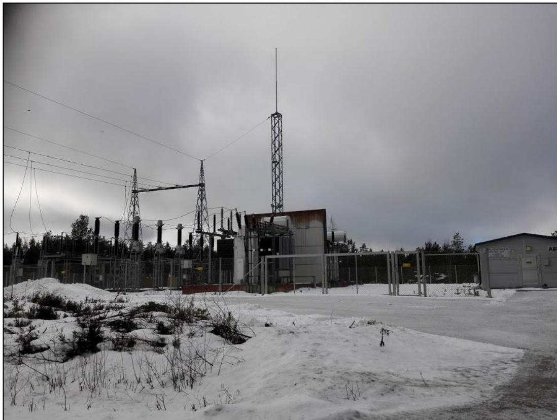
Kuva 3. Hongon sähköaseman suurjännitekenttä ja päämuuntajat (Joni Varjo, 2017)
