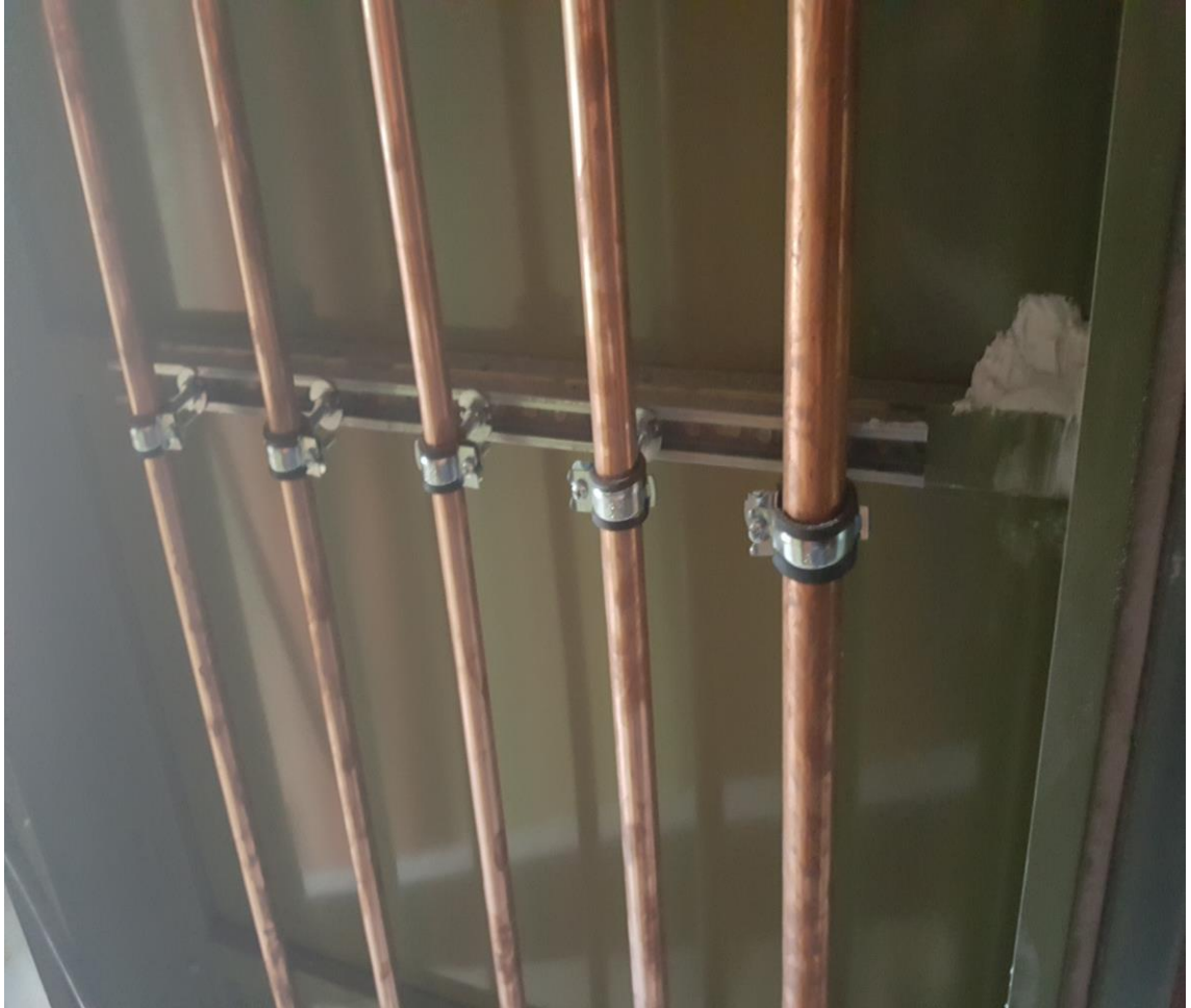
Kuva 3. Kiskot ja käyttövesiputket
