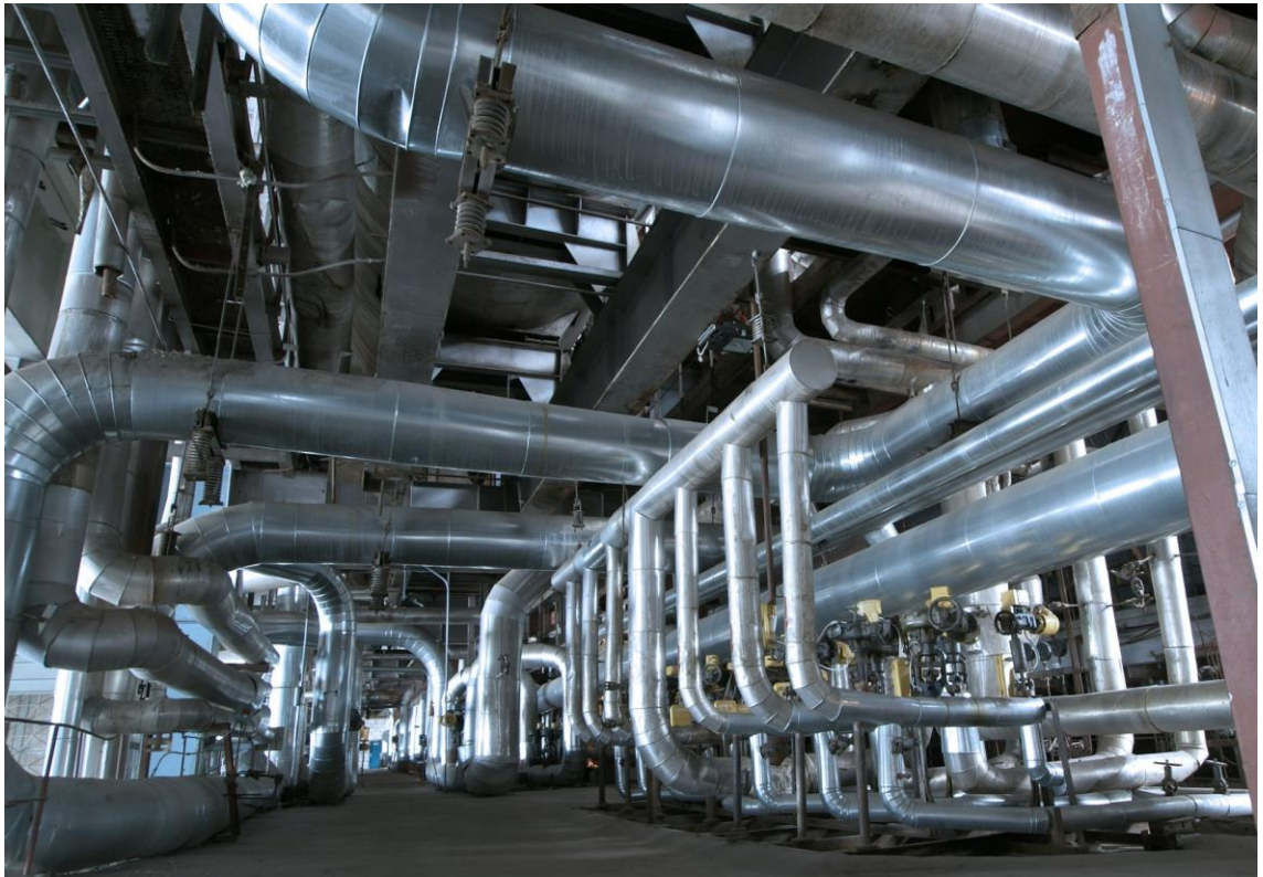
Kuva 2. Mallikkaasti asennettu ilmanvaihtojärjestelmä [19].
