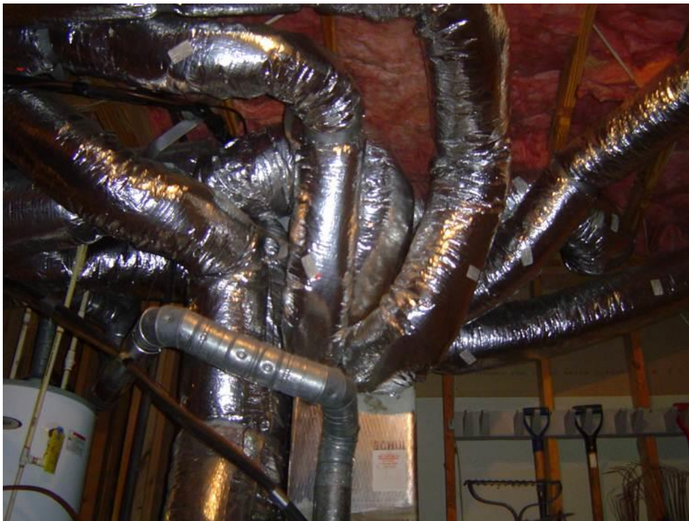
Kuva 1. Huonosti asennettu ilmanvaihtojärjestelmä [18].
