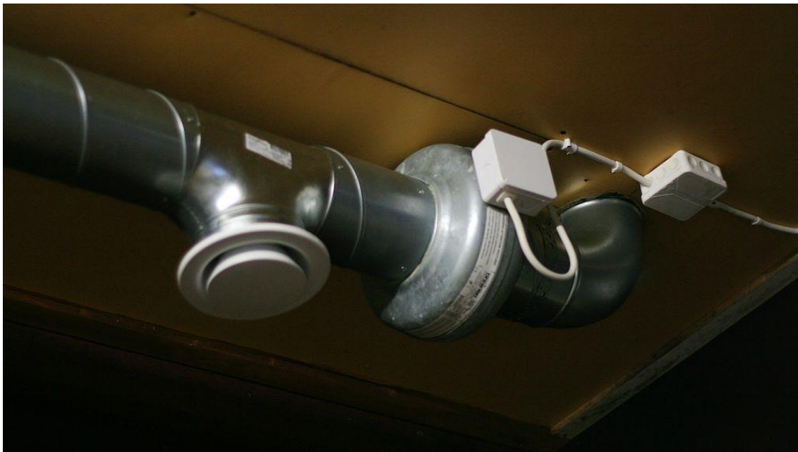
Kuva 4. Kanavapuhaltimella toteutettu poistoilmanvaihto.
