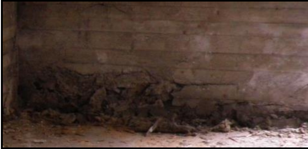
Kuva 3. Kosteuden ja pakkasen rapauttama kellarinseinä
