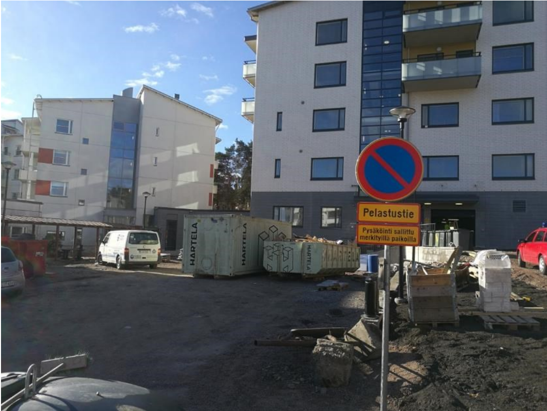
Tilapäinen este pelastustiellä (valokuva on otettu työmaalta ennen rakennuksen käyttöönottoa).
