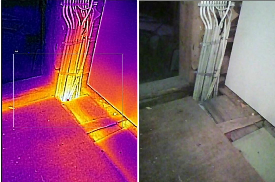
KUVA 5. Lämpökuvaa yläpohjan sähköjohtojen läpiviennistä
