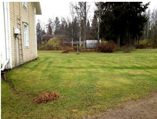
KUVA 2. Pohjoispäädyn maanpinnan kallistukset johtavat rakennuksen vierustaa kohti
