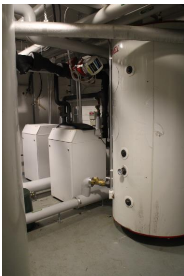
Kuva 13. Lämpöpumppu ja lämminvesivaraaja.
