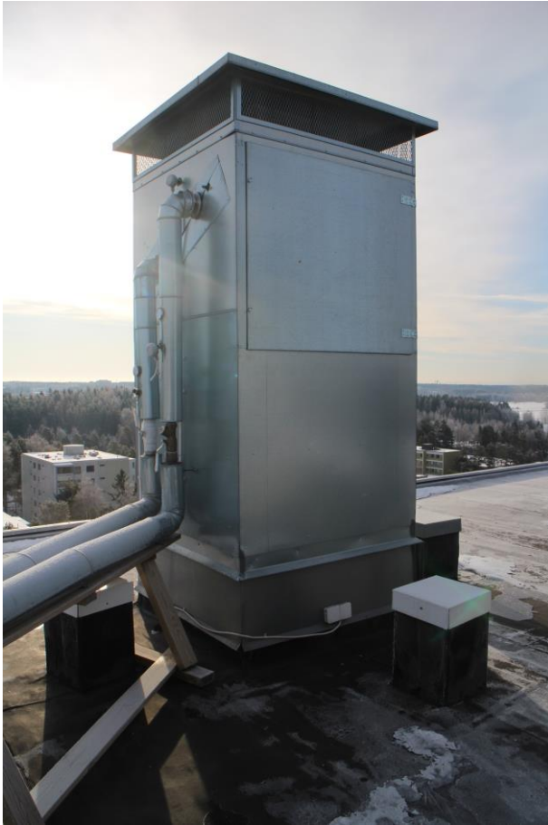
Kuva 14. Rasinkatu 4 katolla oleva lämmöntalteenottojärjestelmän patteri.
