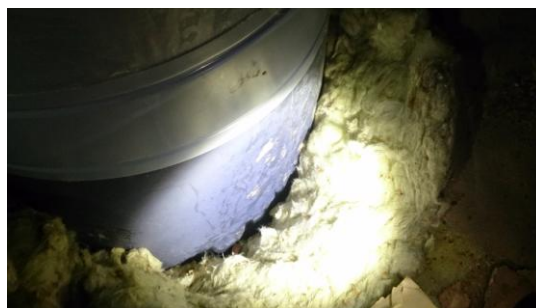
KUVA 12. Ilmavuoto yläpohjan läpiviennissä
