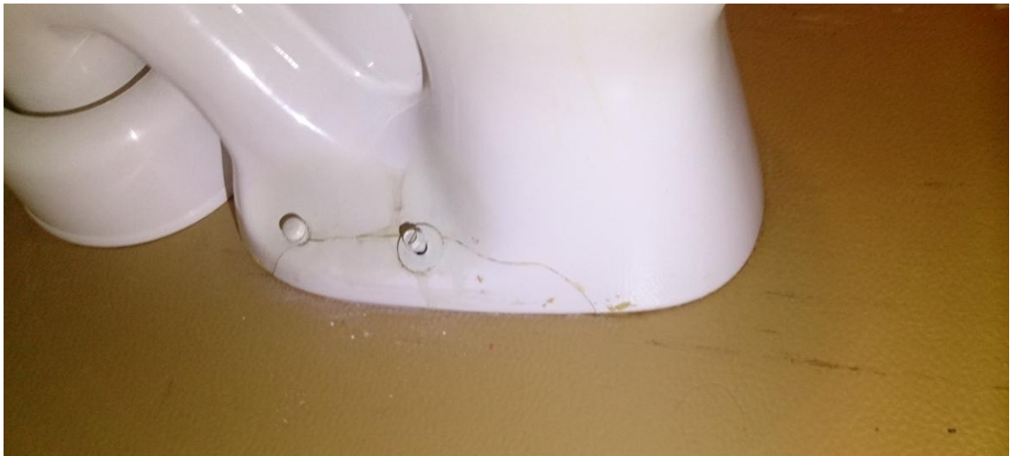
KUVA 32. Wc- istuimen halkeama
