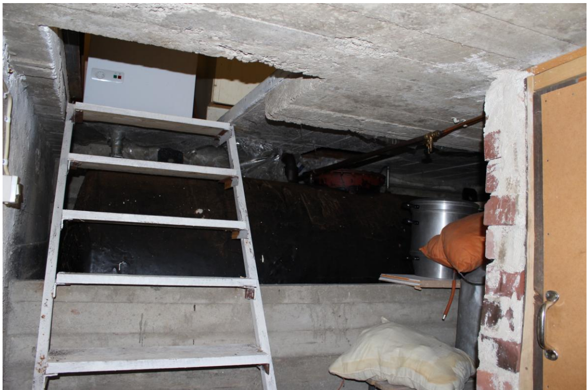
KUVA 39. Kellarissa sijaitseva öljysäiliö
