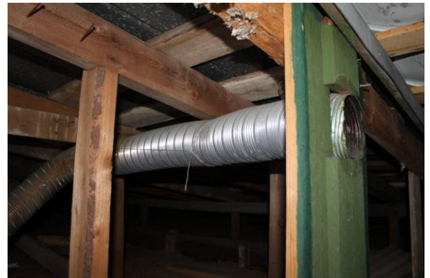
KUVA 7. Autotallin poistoilmaputki yläpohjassa.
