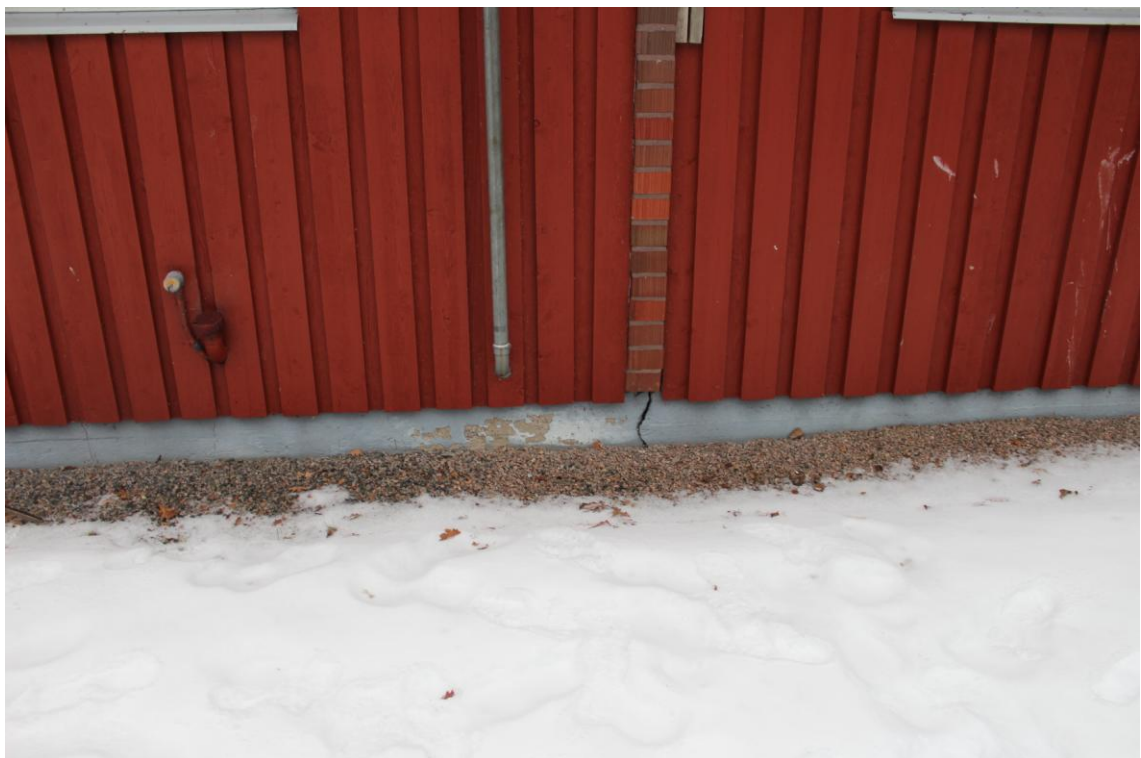
KUVA 25. Sokkelin rapauma ja liitoskohdan halkeama.
