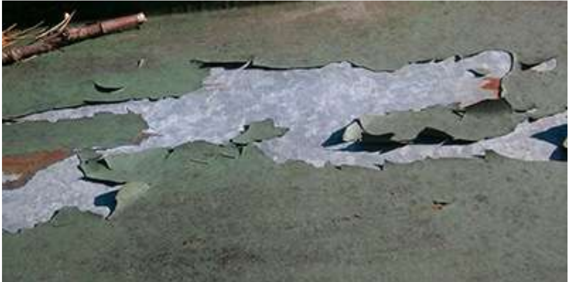
Kuvio 1. Ruosteenpoiston ja huoltomaalauksen tarpeessa olevaa kattopintaa. (Katon maalaus – peltikaton huoltomaalaus 2016.)
