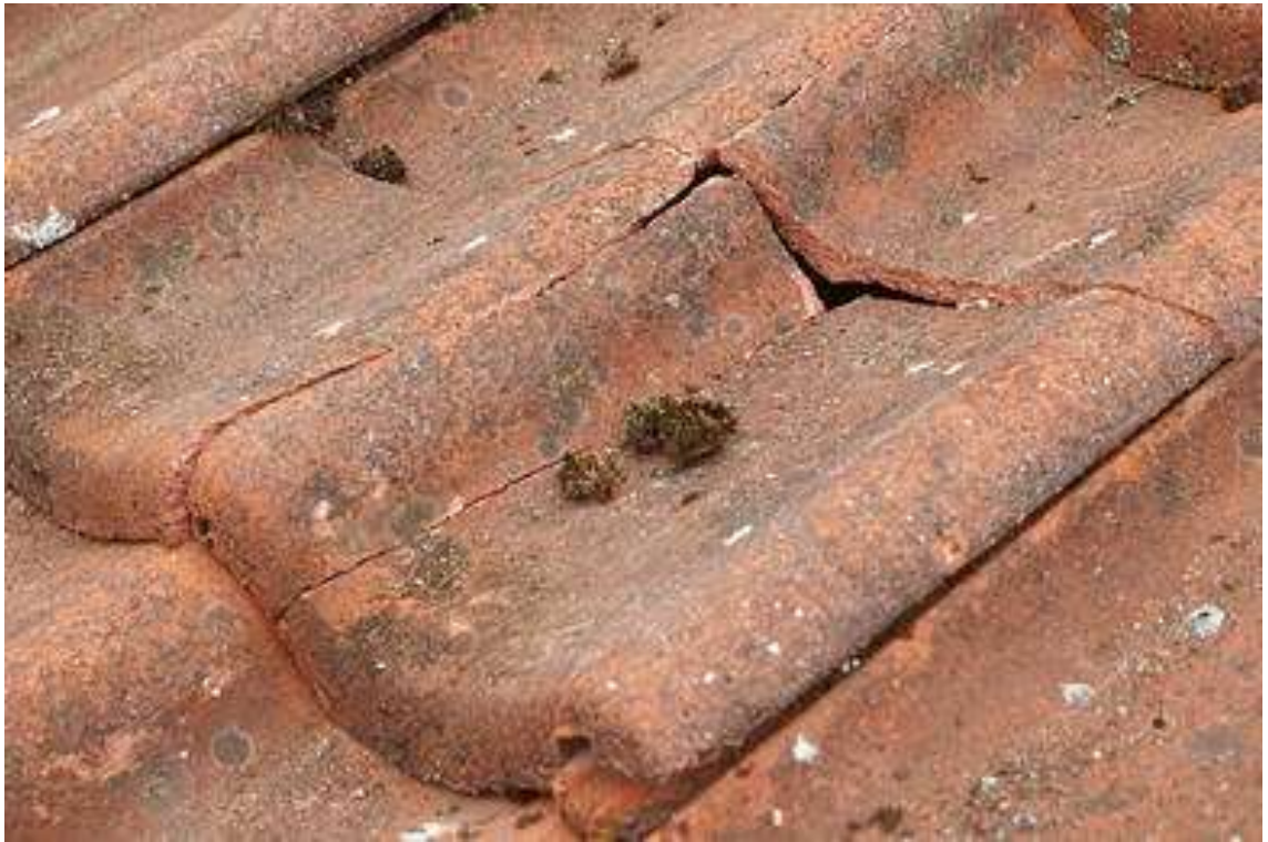
Kuvio 2. Rikkoutunut tiili, joka täytyy vaihtaa. (Haljennut kattotiili 2010.)
