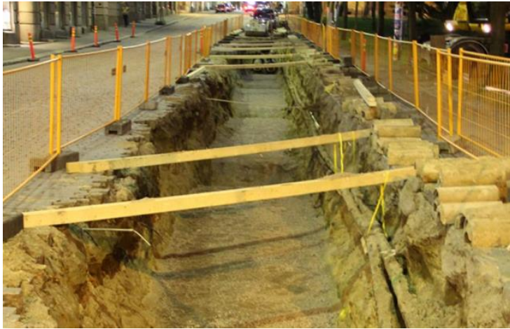
KUVA 3. Esimerkkikuva kaapelien tuennasta (Matikainen 2015, 11).
