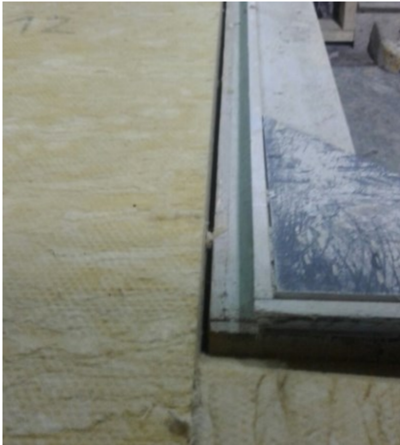
Kuva 8. Eristys jäi epätarkan mitoituksen johdosta harvaksi. Tämä aiheuttaa turhia korjauskustannuksia tehtaalla.
