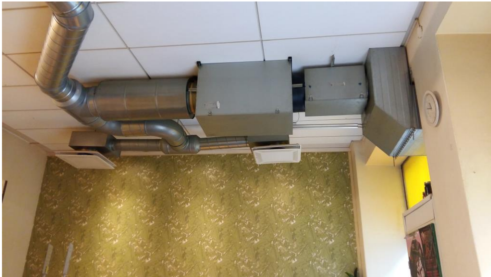
Kuva 7. Katon pinnassa kulkeva ilmastointi (Riesen 2016)
