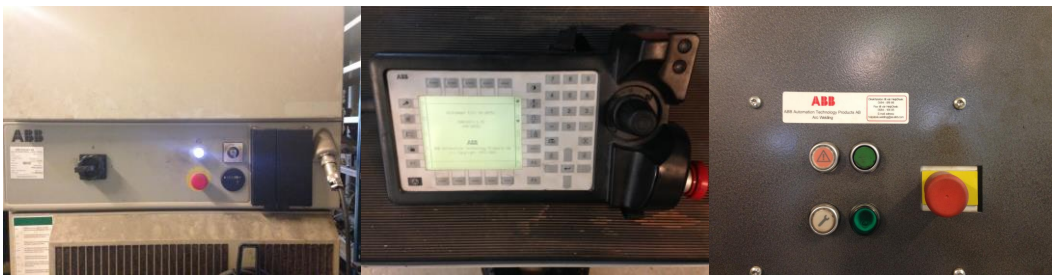
Figur 7. Nödstopp för robotcellen (Löv 03/2017)
