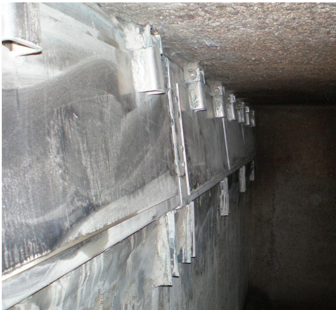
Kuva 7. HSY:n perinteinen tulvaluukku ylivuotokaivossa 082
