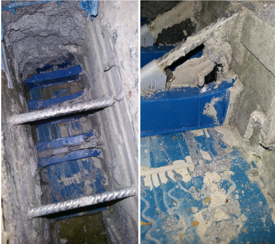
Kuva 9. Isokorb liitososa valmiissa rakenteessa. Lämmöneriste on poistettu jolloin paljastuvat yläpinnan vetoraudoitteet ja alapinnan siniset puristusosat.
