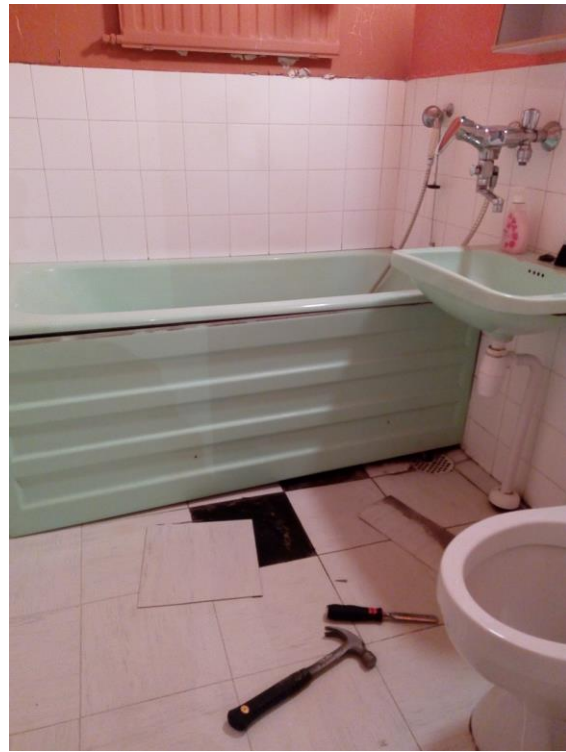
Bild 8. Badrum i höghus byggt 1961. Ursprungliga golvmaterialet är vinylplattor fastlimmade med asbesthaltigt bitumenlim.
