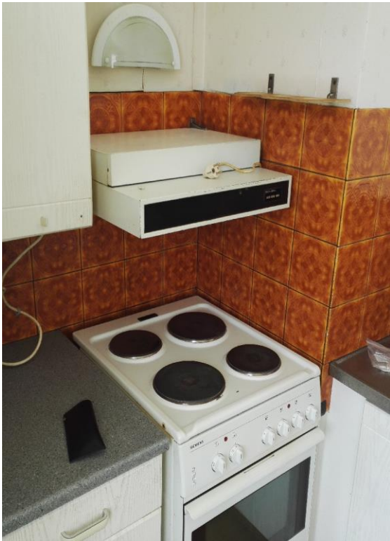
Bild 15. Kök i höghus byggt 1971. Den ursprungliga fogmassan, fastsättningsbruket och väggspacklet innehåller asbest.
