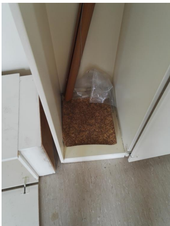
Bild 21. Utskuren bit av asbesthaltiga golvmatta i skåp i lägenhet från 1950-talet.
