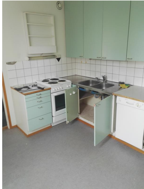
Bild 16. Kök i höghus byggt 1975. Den ursprungliga fogmassan, fastsättningsbruket och väggspacklet innehåller asbest.
