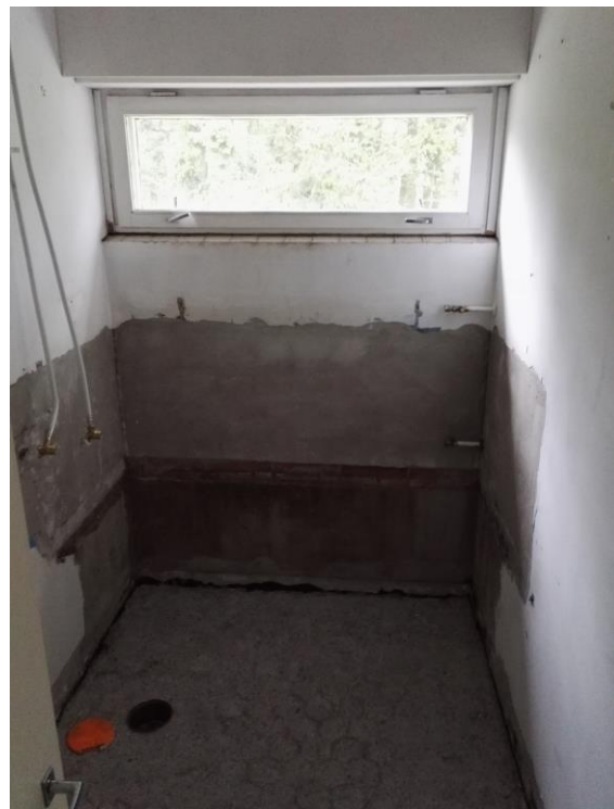
Bild 10. Badrum i höghus byggt 1967. Badrummets ursprungliga vägg- och golvkakels fastsättningsbruk samt väggspackel innehåller asbest. Det asbesthaltiga väggspacklet har dock lämnats kvar på väggarna.
