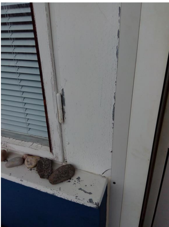
Bild 25. Asbesthaltig skiva mellan fönster och dörr på balkong i höghus byggt år 1963.
