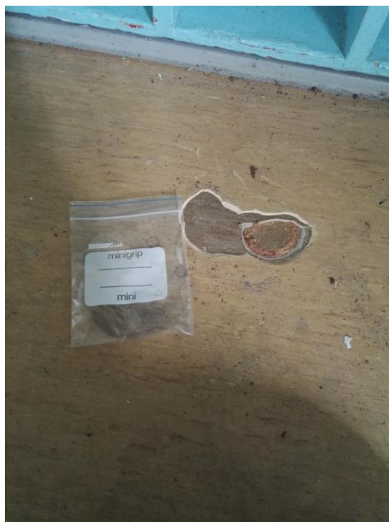
Bild 20. Asbesthaltig "magnesiummassalattiamatto" (den undre mattan) påträffad i lägenhet från 1950-talet.
