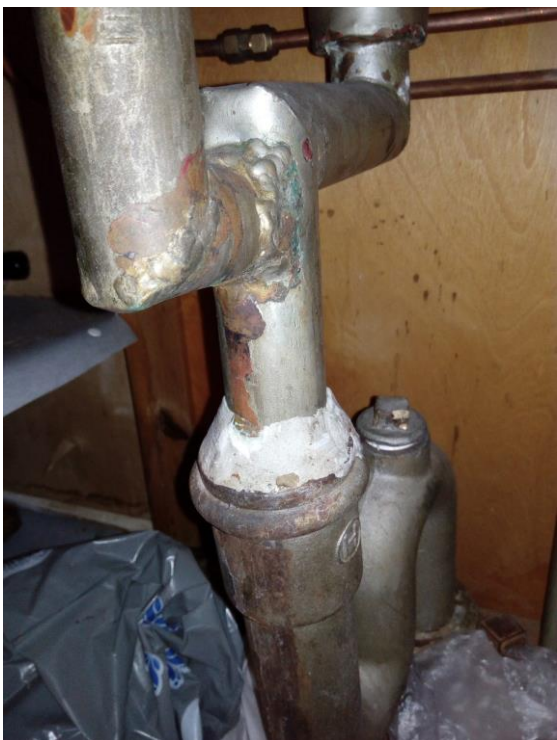
Bild 28. Gjutjärnsavloppsmuff tätad med asbestmassa i höghus byggt år 1958.
