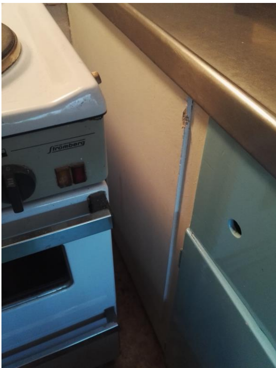
Bild 23. Asbesthaltig brandskyddsskiva intill köksugn i höghus byggt år 1957.
