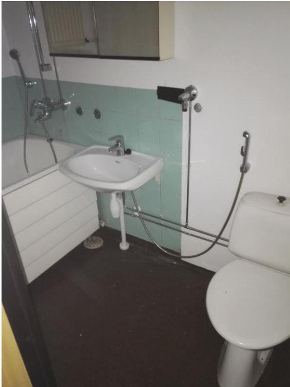
Bild 11. Badrum i höghus byggt 1975. Ursprungliga fastsättningsbruket och fogmassorna samt alla väggars spackel innehåller asbest. Dock innehåller golvmattan, limmet eller golvspacklet inte asbest.
