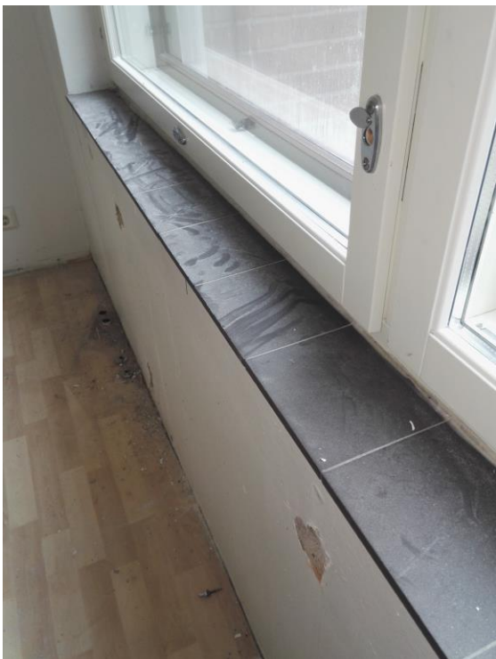
Bild 26. Kakerl på fönsterbräde fastsatta med asbesthaltigt fastsättningsbruk i höghus byggt år 1974.
