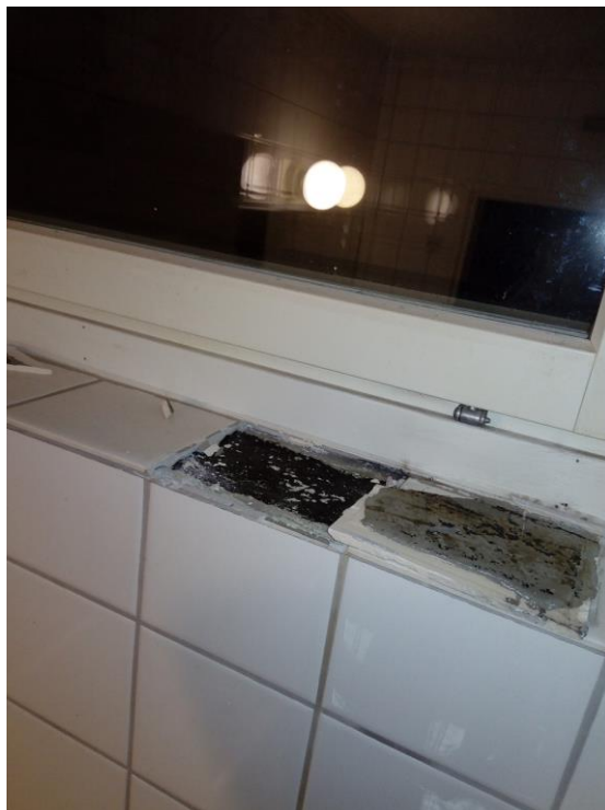
Bild 27. Spår av asbesthaltigt bitumenlim på fönsterbräde i badrum i höghus byggt år 1964.
