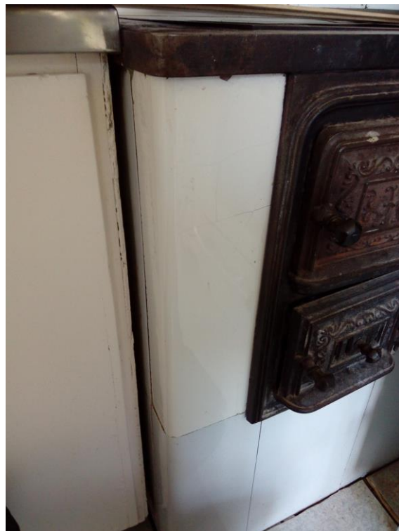
Bild 24. Asbesthaltig brandskyddsskiva intill kakelugn i höghus byggt år 1928.
