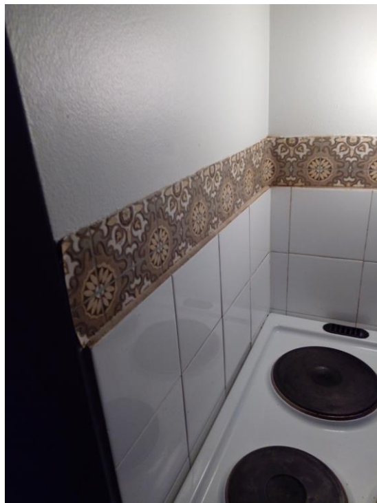
Bild 22. Kök dekorerat med utskurna remsor av asbesthaltig golvmatta i 1964 byggd lägenhet.
