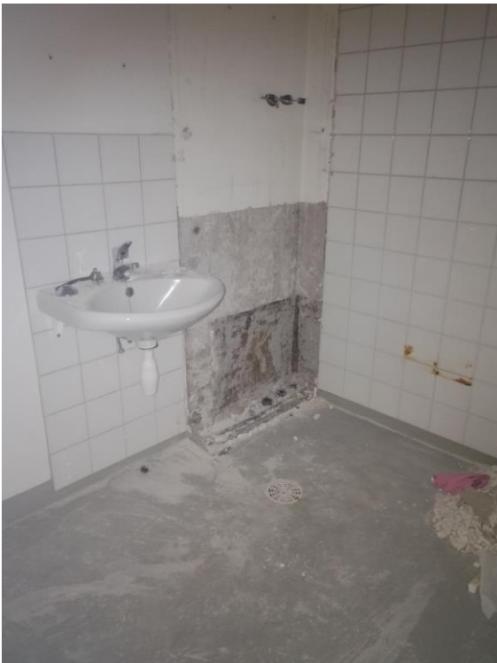
Bild 9. Badrum i höghus byggt 1974. Badrummet har renoverats på 1990-talet men det ursprungliga asbesthaltiga fastsättningsbruket har lämnats kvar (det ljusgråa på bilden).
