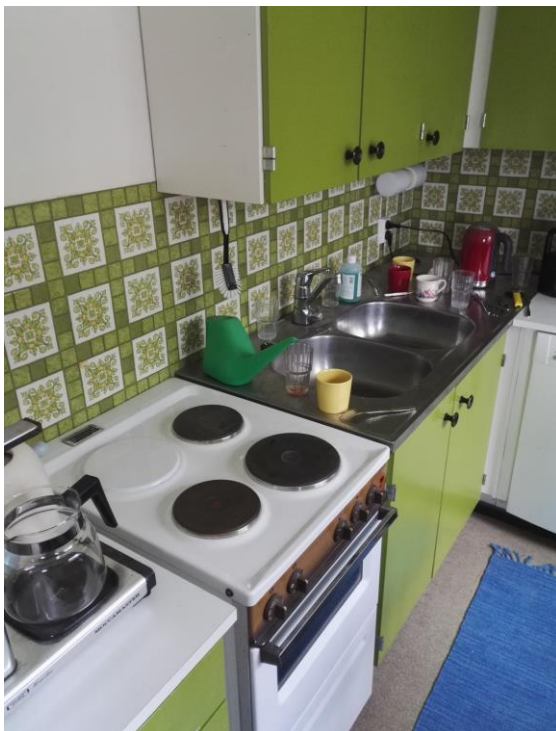
Bild 17. Kök i höghus byggt 1977. Den ursprungliga tapeten i köksskåpsmellanrummet innehåller asbest.
