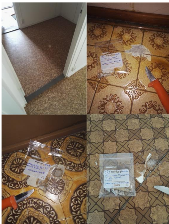
Bild 19. Asbesthaltiga "joustovinyylimatto" i olika mönster och storlek från olika årtionden.
